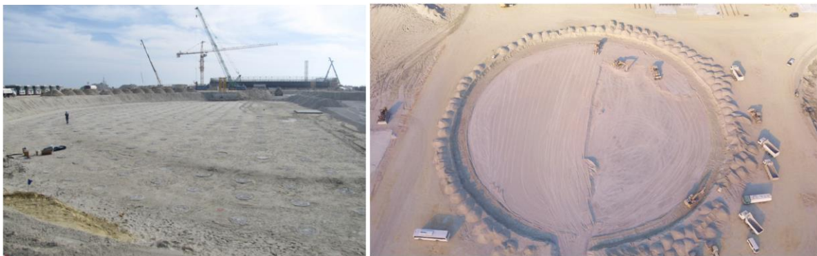
Figura 24 – Vista geral da construção das inclusões e da PTC (Bernuy et al., 2018)
