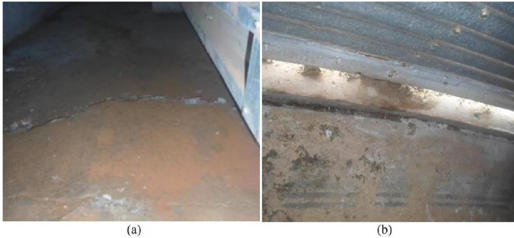
Figura 40 - Trinca na laje do silo (a) e recalque excessivo entre a viga do anel do silo e a laje (b) (Bernardes, et al., 2021)
