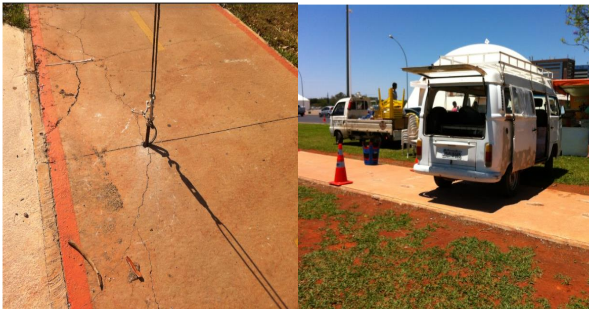
Figura 18 - Uso inadequado da ciclovia: (a) fixação de estrutura para evento; (b) veículo estacionado sobre a ciclovia.
