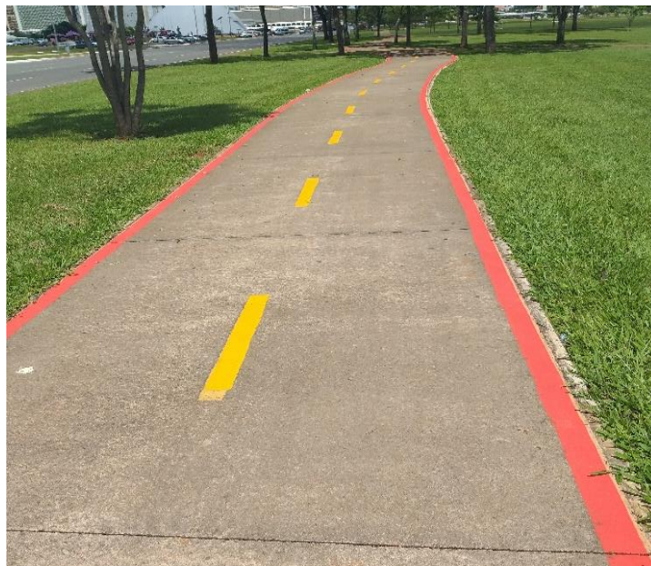
Figura 16 – Imagem ilustrativa da superfície do pavimento da ciclovia rígido, produzido em concreto, do trecho da Esplanada dos Ministérios, registrado durante a fase de inspeção dessa pesquisa
