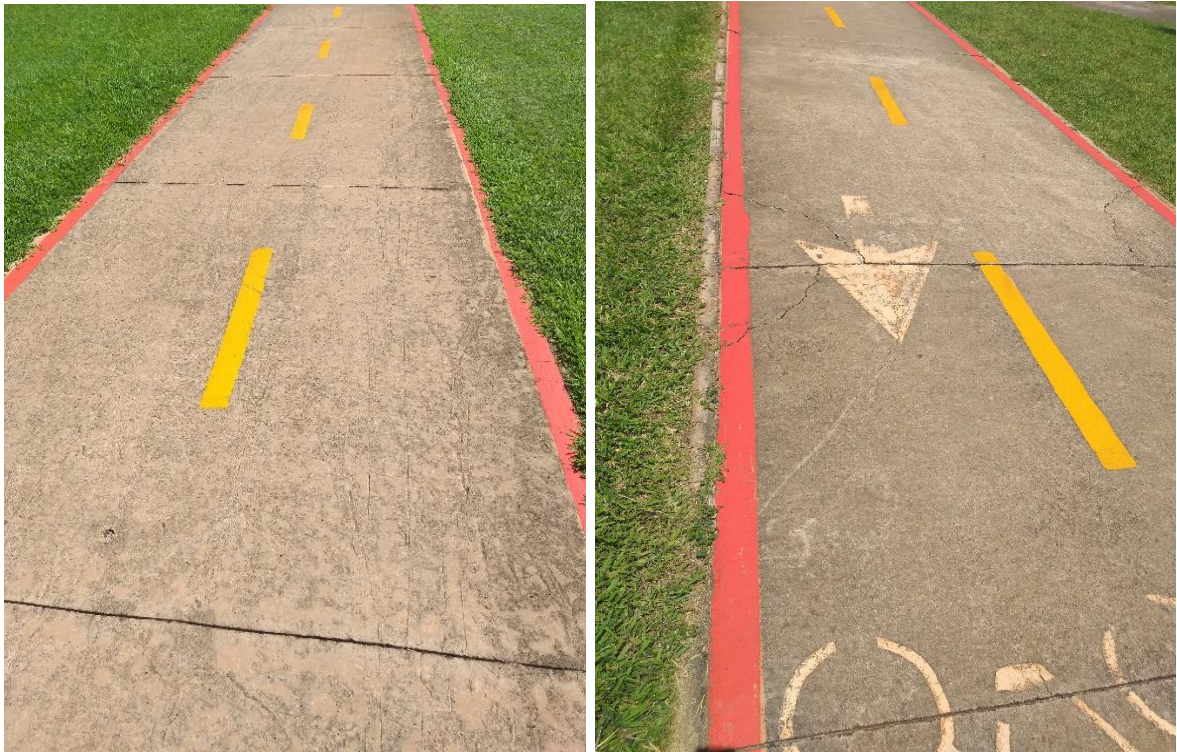
Figura 9 - Falta de selagem nas juntas
