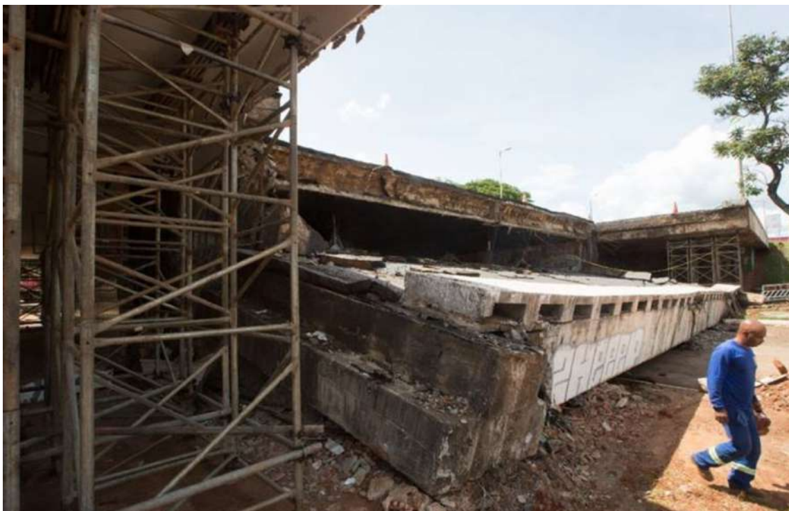
Figura 119 - Local do desabamento do Viaduto sobre a Galeria dos Estados. Fonte: Vinicius Cardoso Vieira/CB/DA Press
