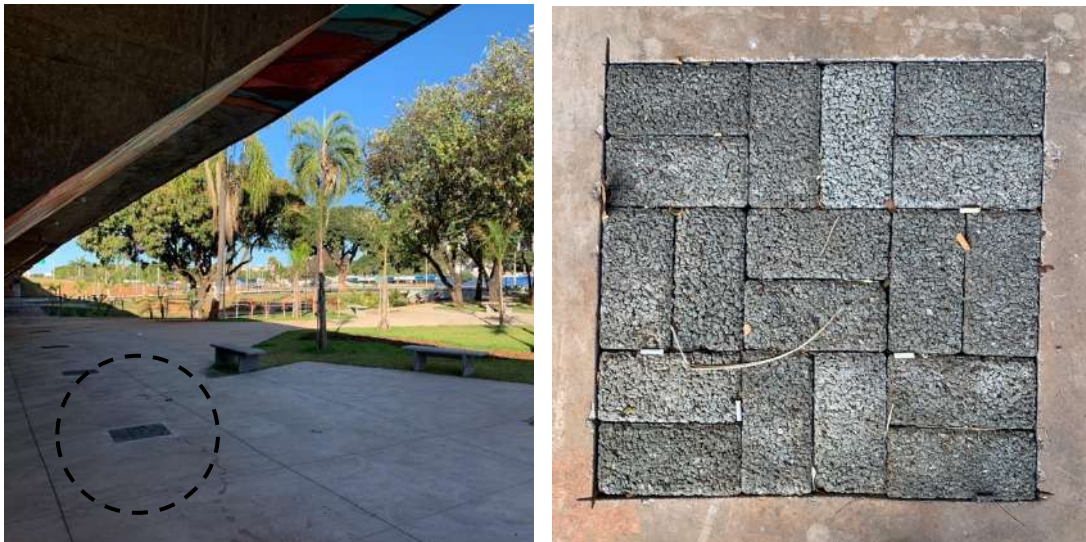
Figura 116 - Ponto de escoamento em pavimentação drenante, concreto permeável, Viaduto sobre a Galeria dos Estados, Brasília, DF (Fonte: autoral)
