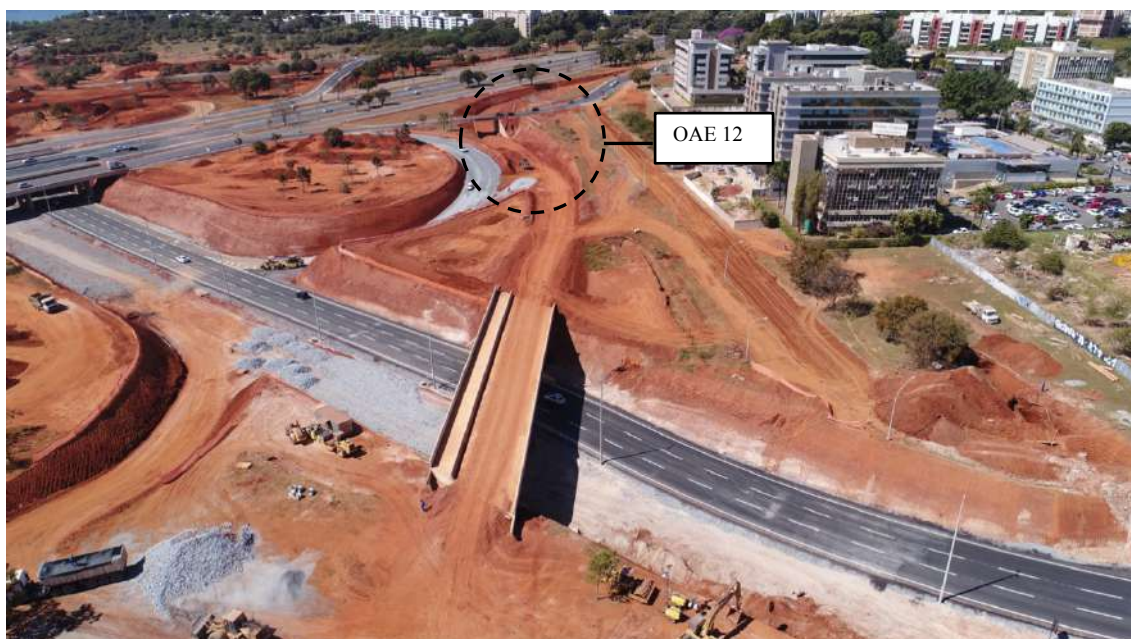
Figura 268 – Vista aérea da OAE 10, na frente, e da OAE 12, atrás. TTN, Brasília, DF. Fonte: DER/DF, 2018
