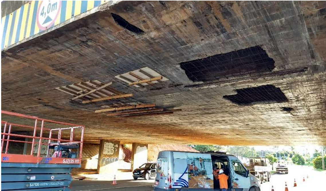
Figura 222 - Laje inferior mostrando seu estado precário antes do retrofit estrutural, Ponte do Braghetto, Brasília, DF. Fonte: DER / DF, 2018
