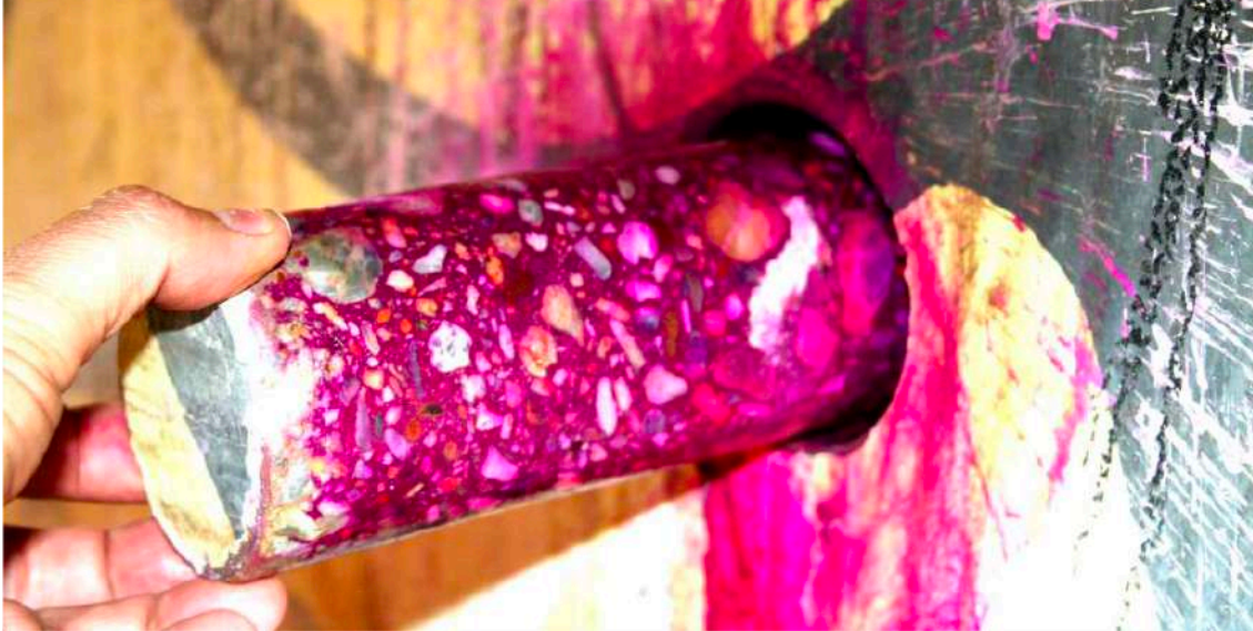
Figura 123 - Extração do corpo de prova mostrando carbonatação. Fonte: RELATÓRIO TÉCNICO Dept. ENC/UnB 001 (2018)
