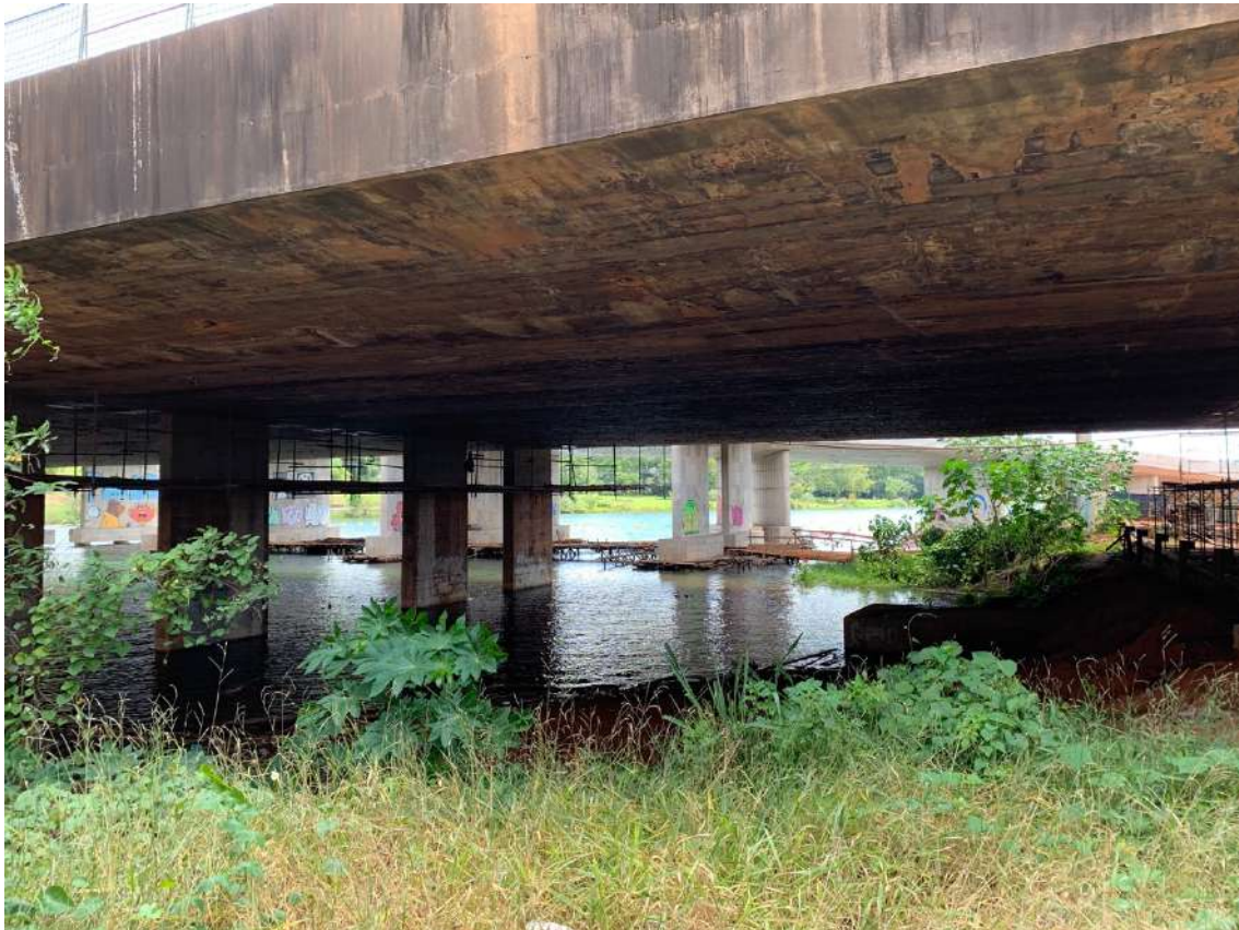
Figura 221 - Laje inferior da ponte do Braghetto antes do retrofit estrutural, Trevo de Triagem Norte, Brasília, DF. Fonte: autoral
