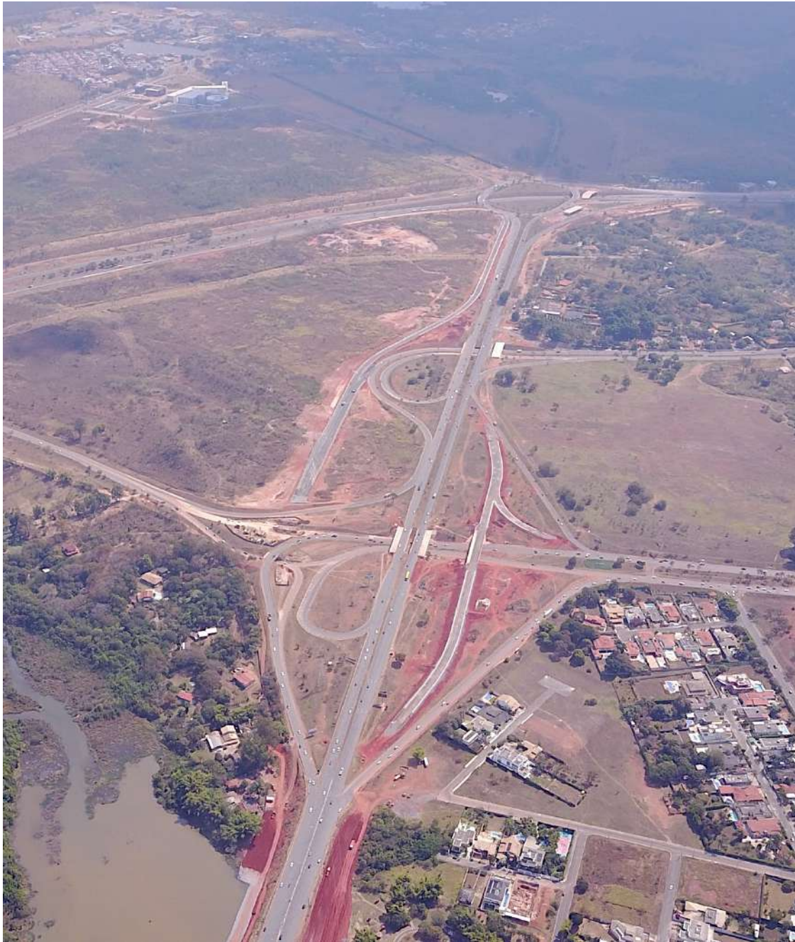
Figura 164 - Vista aérea do trecho sul do Trevo de Triagem Norte, em fase de obra. Fonte: DER/DF
