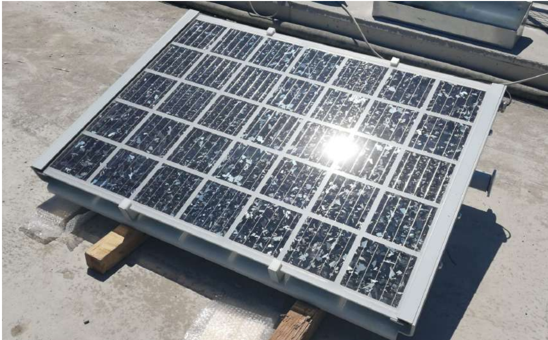
Figura 331 – Píanel fotovoltaico. Fonte: Commissario Ricostruzione Genova
