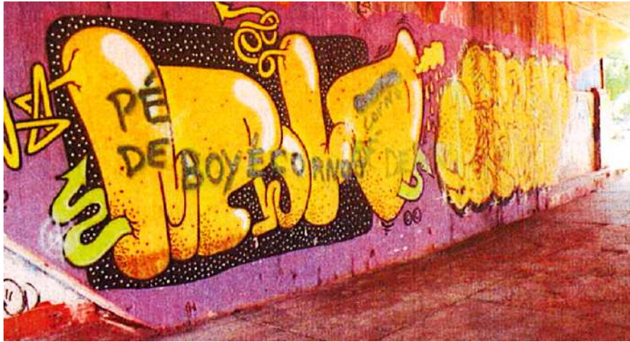
Figura 132 - Pilar 2 antes do Retrofit, lado sul, durante a vistoria visual ao local. Fonte: Laudo de vistoria técnica da NOVACAP (2018)
