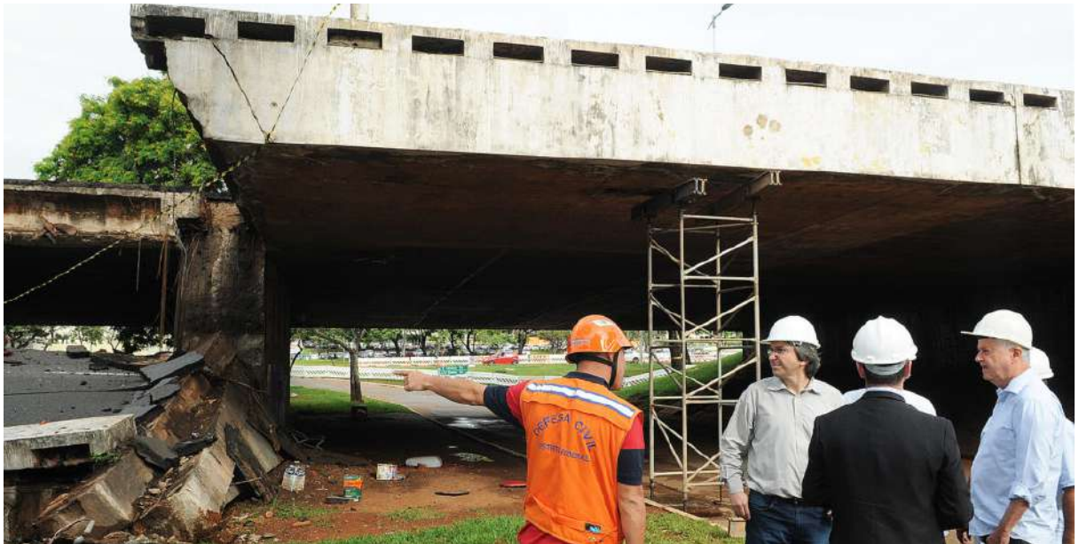
Figura 124 - Trecho do tabuleiro em ruína e área externa antes do Retrofit, Viaduto sobre a Galeria dos Estados, Brasília, DF (Fonte: Tony Winston/Agência Brasília)
