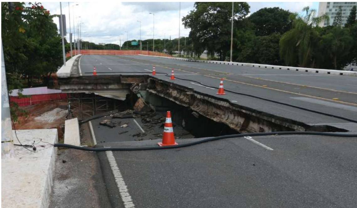
Figura 118 - Vista do elemento de laje em ruína parcial, Viaduto sobre a Galeria dos Estados. Fonte: Fabio Rodrigues Pozzebom / Agência Brasil
