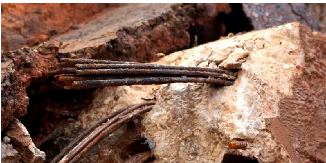
Figura 122 - Corrosão das cordoalhas protendidas. Fonte: RELATÓRIO TÉCNICO Dept. ENC/UnB 001 (2018)
