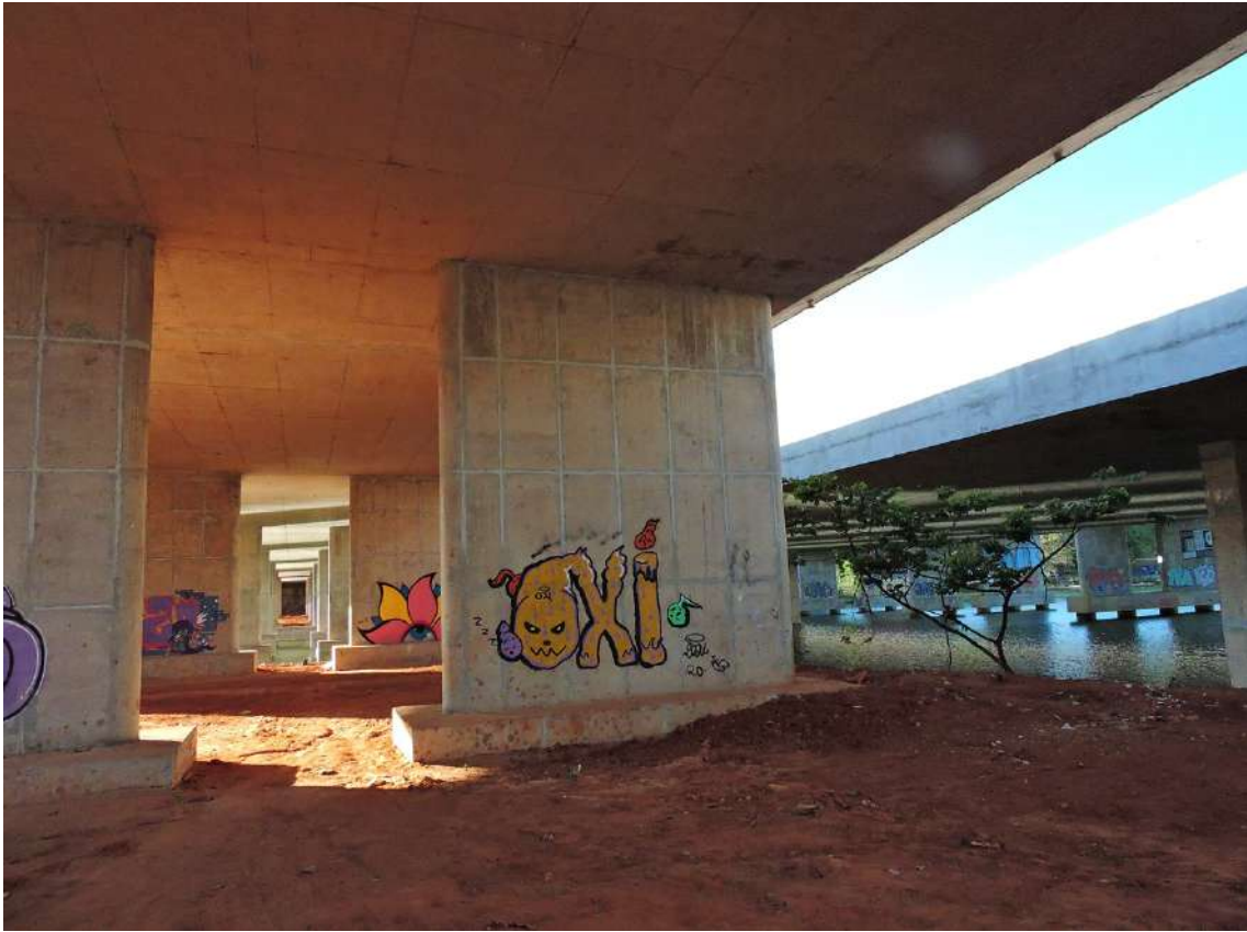
Figura 238 – Vista da OAE 07, a esquerda e Ponte do Braghetto, a direita, complexo do TTN, Brasília, DF. Fonte: autoral
