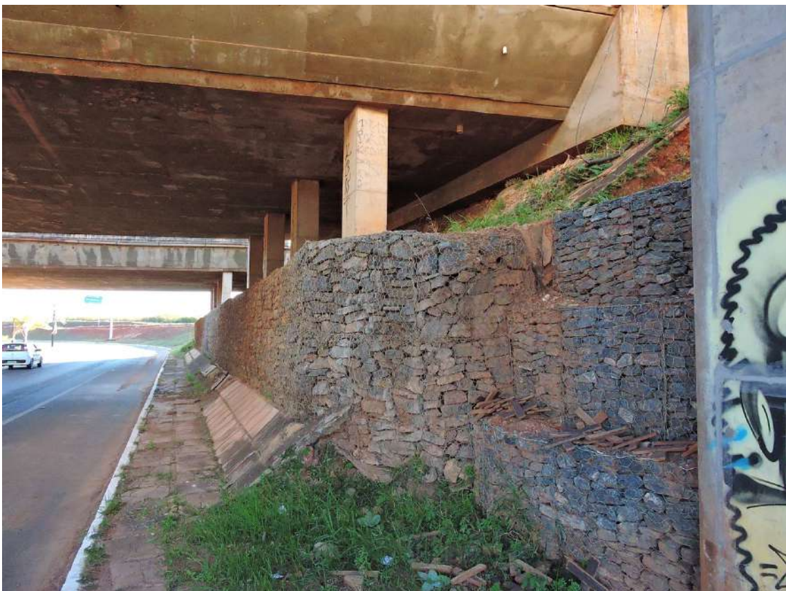
Figura 180 – Contenção em muro de gabião dos viadutos existentes no trecho do TTN, Brasília, DF. Fonte: autoral
