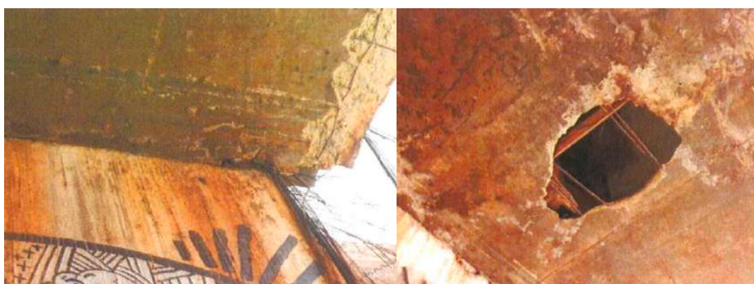
Figura 139 - Manifestações patológicas da Laje L7. De esquerda para direita: armadura ativa exposta e em estado de obsolescência e buraco com armadura exposta. Fonte: Adaptado de Laudo de vistoria técnica da NOVACAP (2018)
