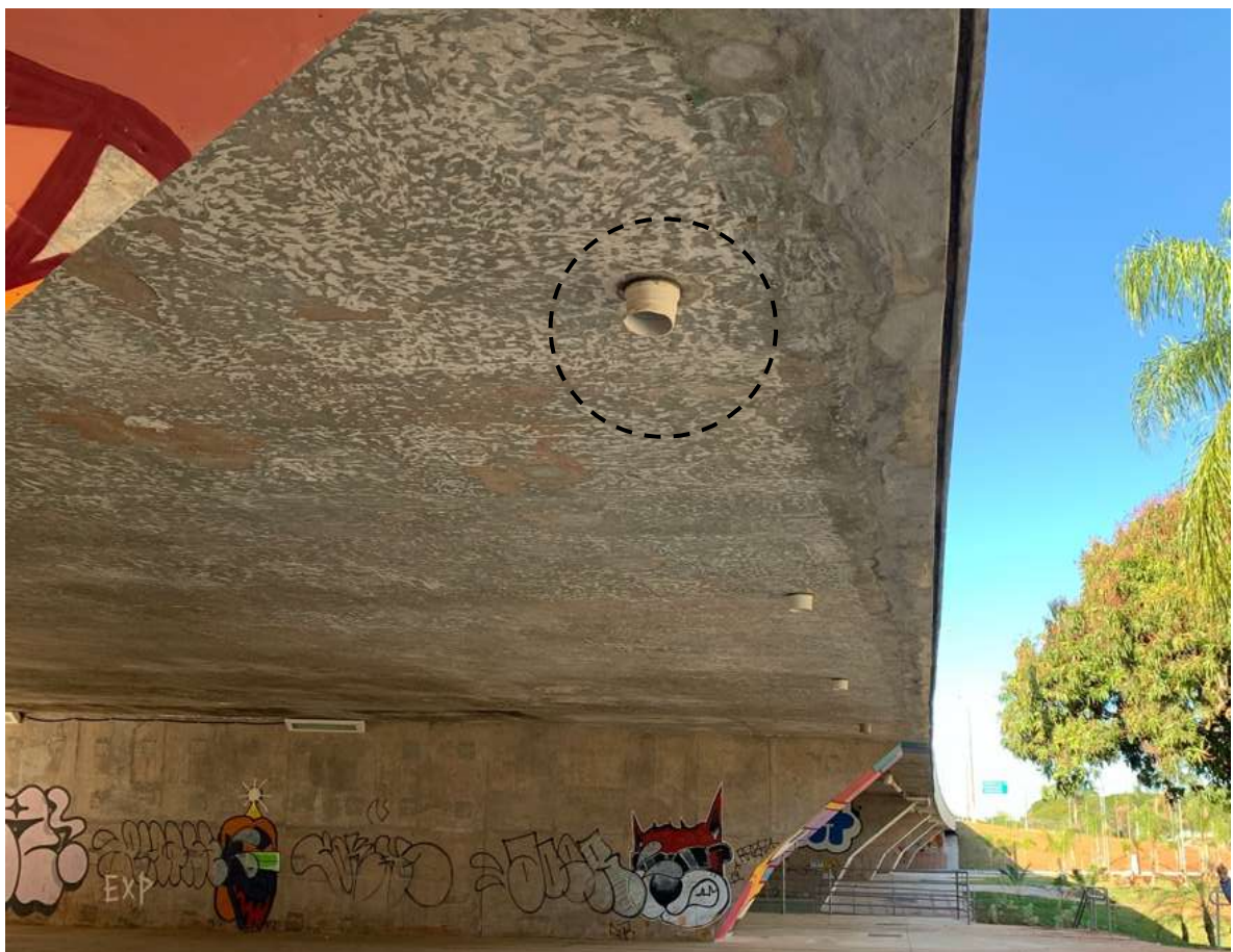
Figura 115 - Buzinetes de escoamento instalados na parte oeste do Viaduto entre os vãos dos pilares P6 e P5. Fonte: autoral
