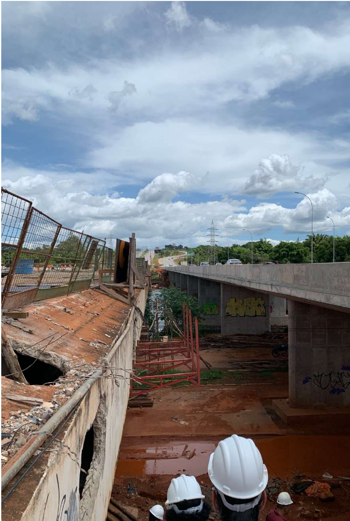
Figura 227 – Galerias laterais da ponte do Braghetto em estado precário, antes do processo de Retrofit, Fonte: autoral
