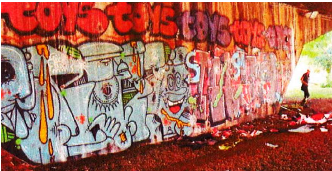
Figura 130 - Pilar 1 antes do Retrofit, lado sul, durante a vistoria visual ao local. Fonte: Laudo de vistoria técnica da NOVACAP (2018)
