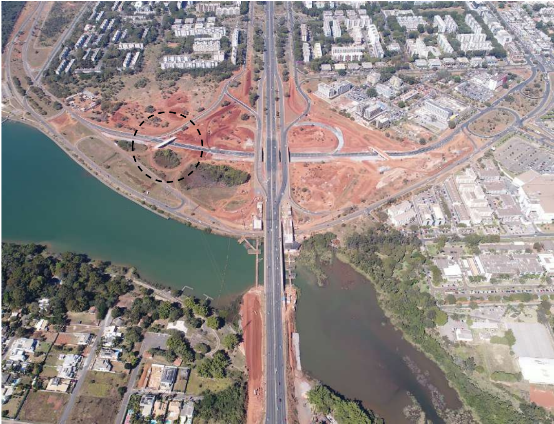
Figura 243 – Vista aérea da construção da área sul do complexo do TTN e da OAE 08. Fonte: DER/DF, 2018
