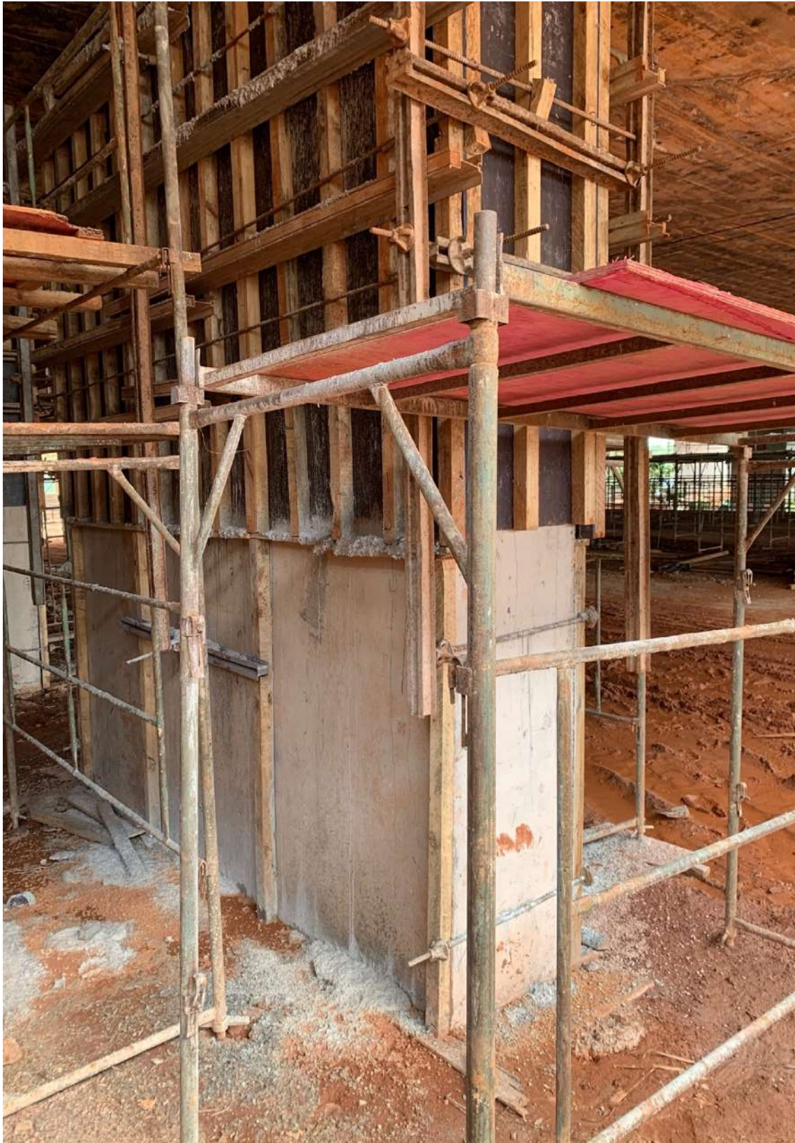
Figura 217 – Formas utilizadas para recobrimento da seção transversal dos pilares da ponte do Braghetto, Brasília, DF. Fonte: autoral
