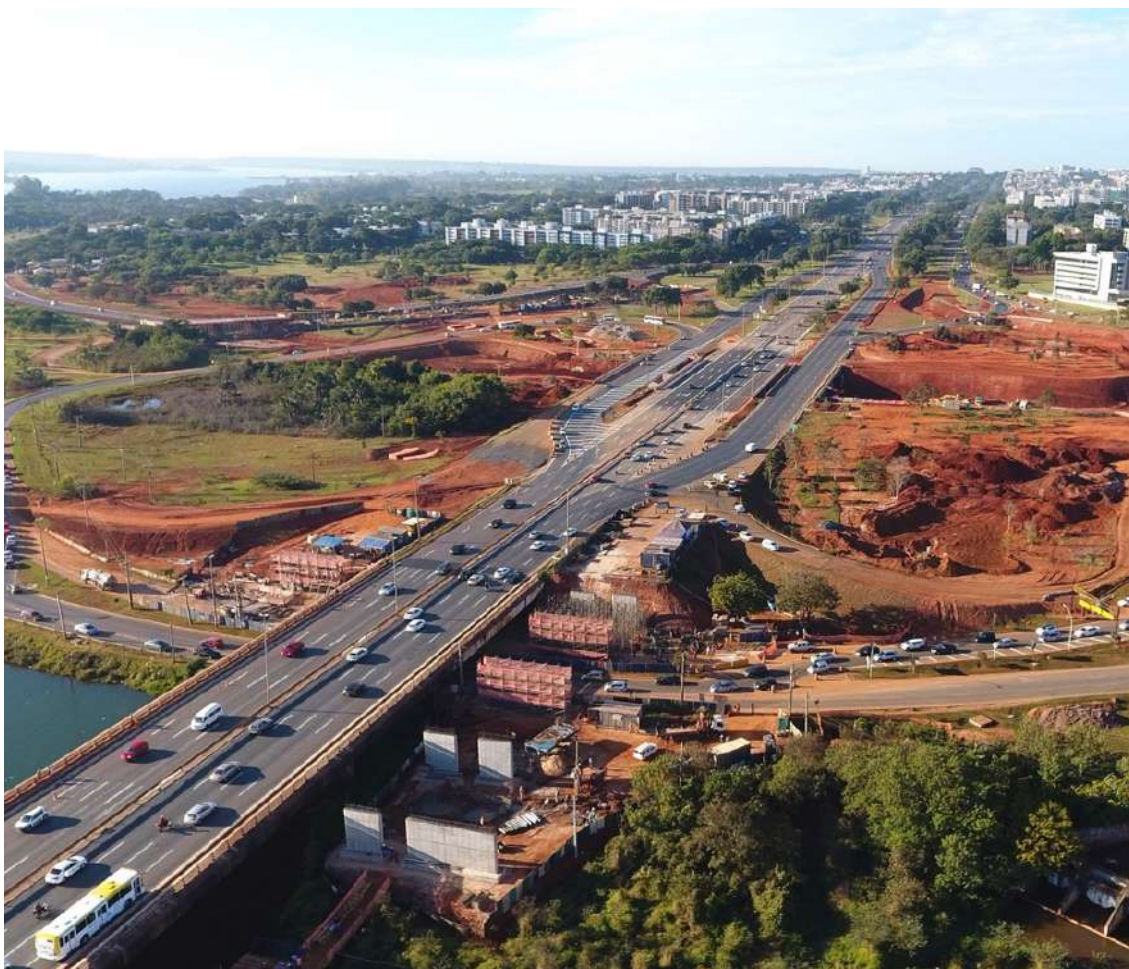
Figura 205 - Ponte do Braghetto antes do retrofit estrutural, Trevo de Triagem Norte, Brasília, DF. Fonte: DER / DF, 2018
