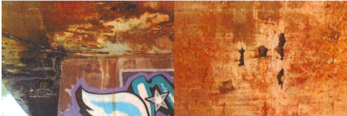
Figura 140 - Manifestações patológicas da Laje L8. De esquerda para direita: infiltração e buraco com armadura exposta. Fonte: Adaptado de vLaudo de vistoria técnica da NOVACAP (2018)
