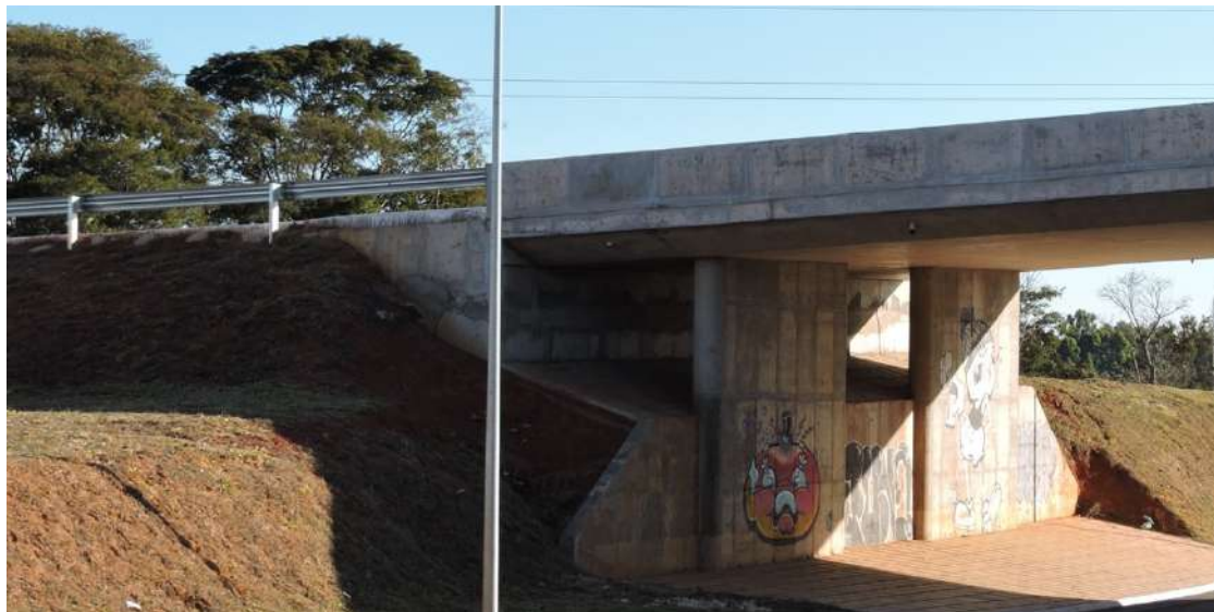
Figura 194 – Saias adicionais de contenção, OAE 05, TTN. Fonte: autoral
