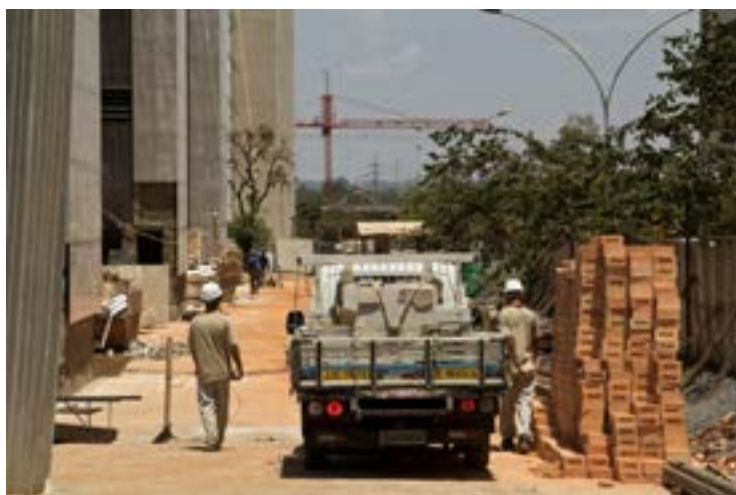
FOTO 29 Trabalhadores da construção civil, durante obra de edificação de um bloco residencial.
