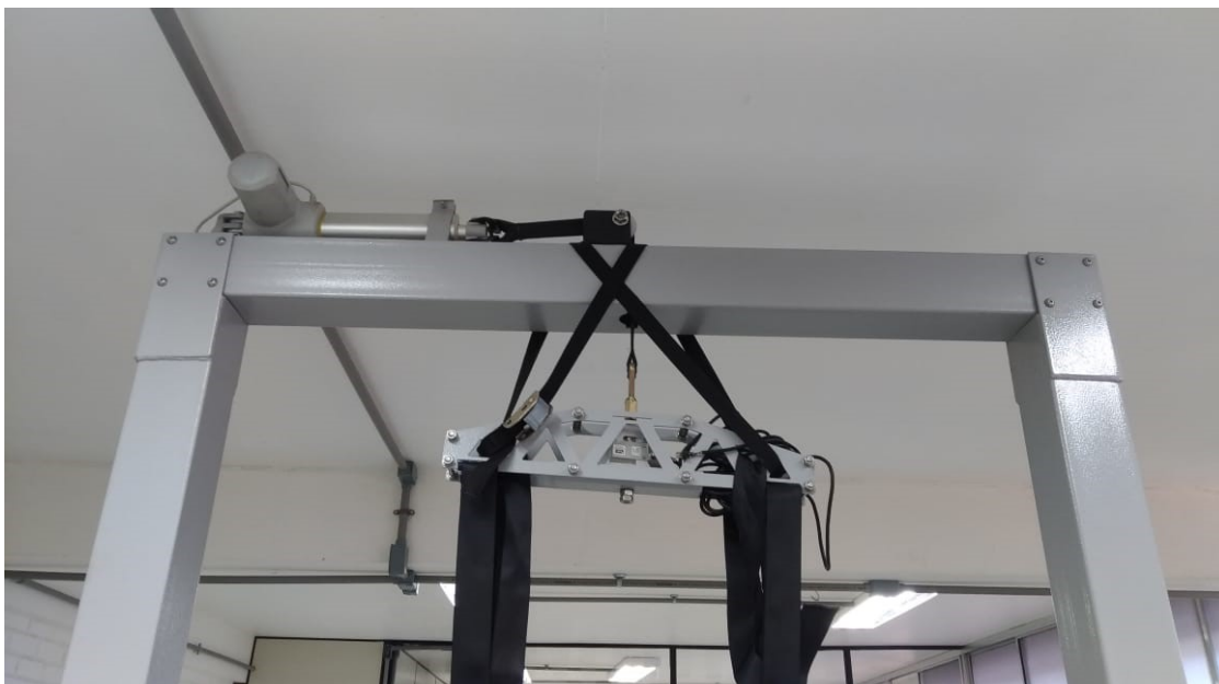
Figura 9. Motor elétrico sobre a trave de Suspensão em detalhe.
