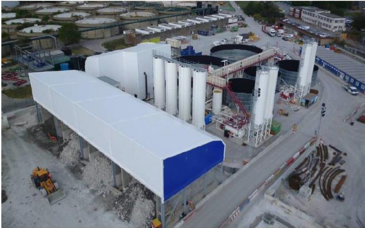
Figura 2.7 – Estação de tratamento utilizada na escavação do Túnel Water Lee (MS SA, 2014).
