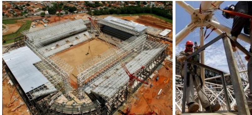
Figura 1.32 – Cobertura da arena Pantanal em Cuiabá com ligação típica com ponteiros (D'Alambert, 2014)
