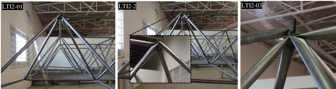
(b) Colapso do protótipo LTI2 com detalhe da ruptura na ligação típica
