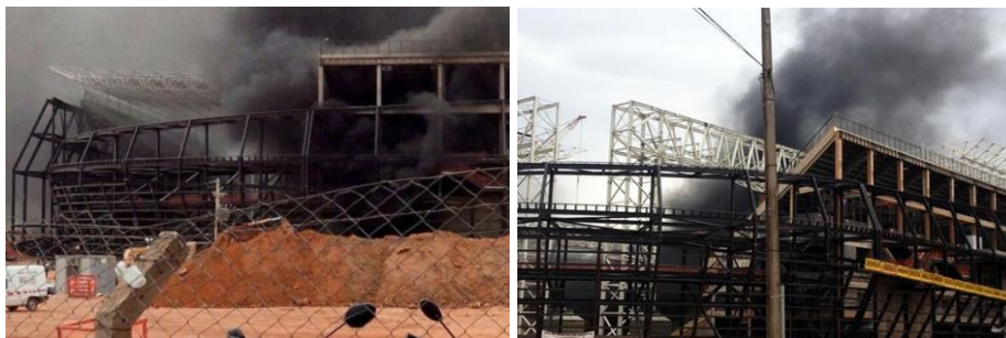
Figura 1.33 – Incêndio ocorrido durante a construção da arena Pantanal (Souza, 2013)
