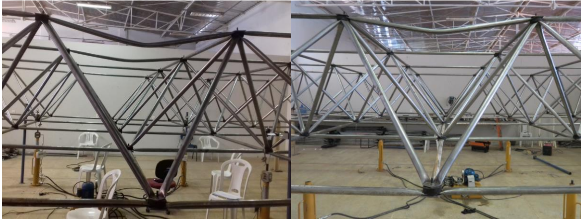
(e) Protótipos LTEDP1 e LTDP2 após o colapso global da treliça
