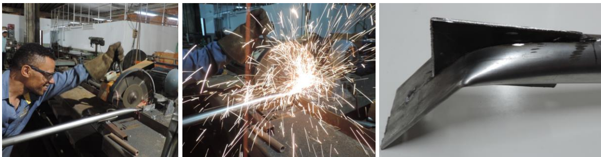
(a) Corte da barra da diagonal para execução do reforço com a chapa reentrante
