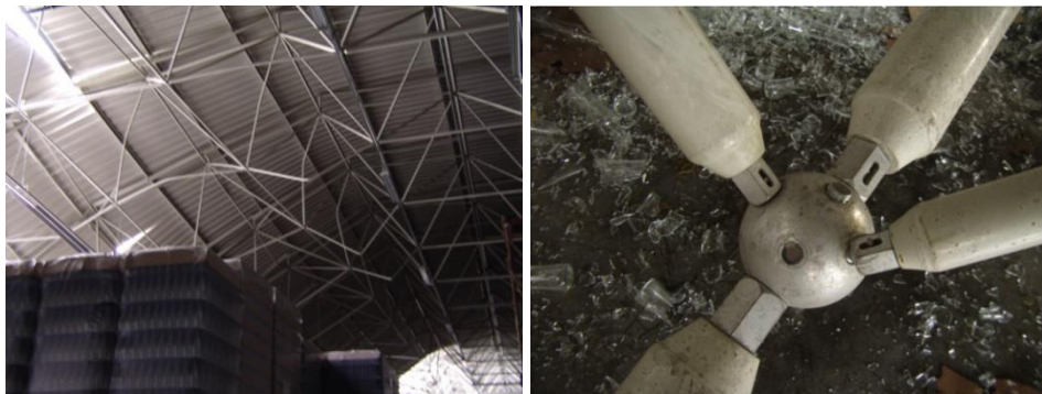
(b) Detalhe da cobertura que colapsou
