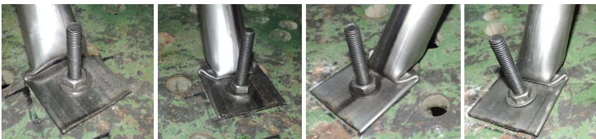
(d) Falha das quatro extremidades das diagonais de apoio
