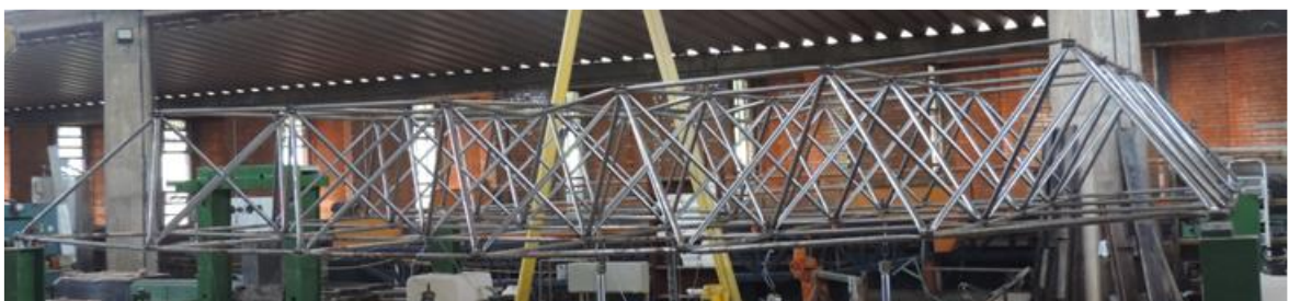
(d) Vistas geral do colapso da LTDCEA1
