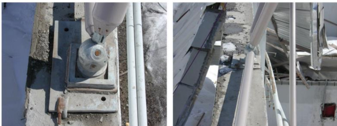
Figura 1.22– Colapso da cobertura de um galpão na parte oriental da Turquia (Caglayan e Yuksel, 2008)
