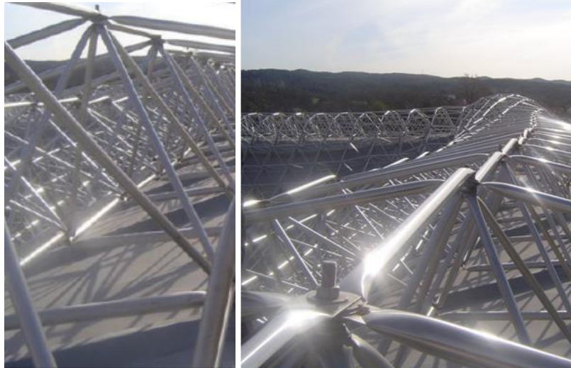
(a) Imagem antes do colapso (b) Imagem depois do colapso da cobertura Figura 1.15 – Detalhe da cobertura da treliça do Ginásio poliesportivo de Gerona (Alegre, Ródenas e Villalba, 2012)
