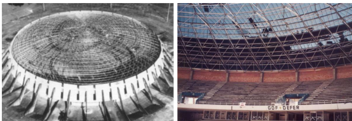
(a) Colapso da cobertura durante execução
