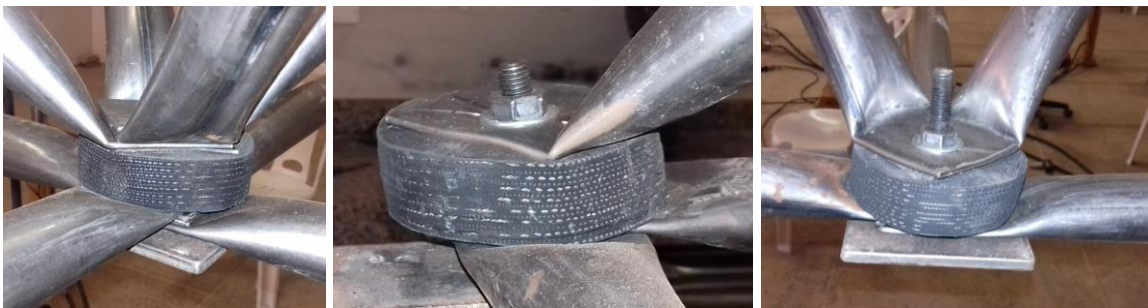
(f) Dois distanciadores nos apoios do protótipo na coluna e outro na ligação intermediária
