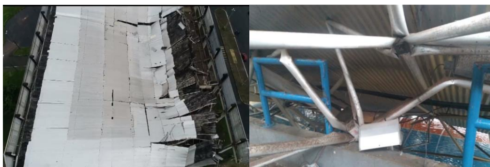
(a) Detalhe do Colapso da cobertura
