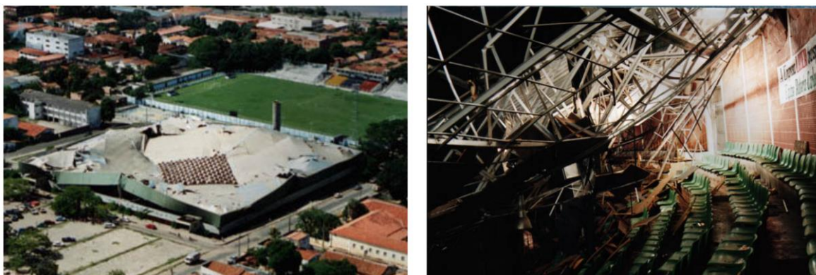
Figura 1.30 – Colapso do Parque de Exposição e Ginásio Dirceu Arcoverde. (Sampaio, 2004) e (Araújo, 2013)
