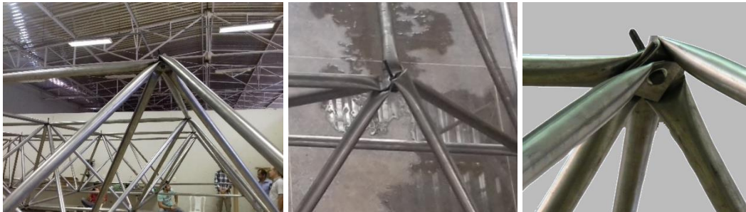
(a) Detalhe do colapso das duas ligações LTI1 e LTI2 e vista inferior da LTI2
