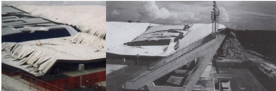
Figura 1.28 – Fotos da cobertura após o colapso (Souza, 2003) e (Freitas, 2008)
