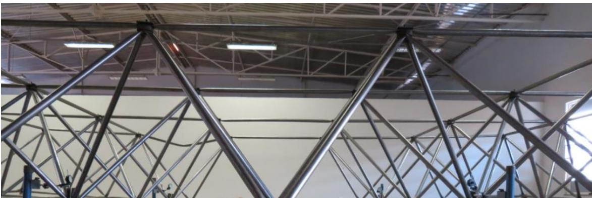
(b) Colapso do protótipo LTDFV2
