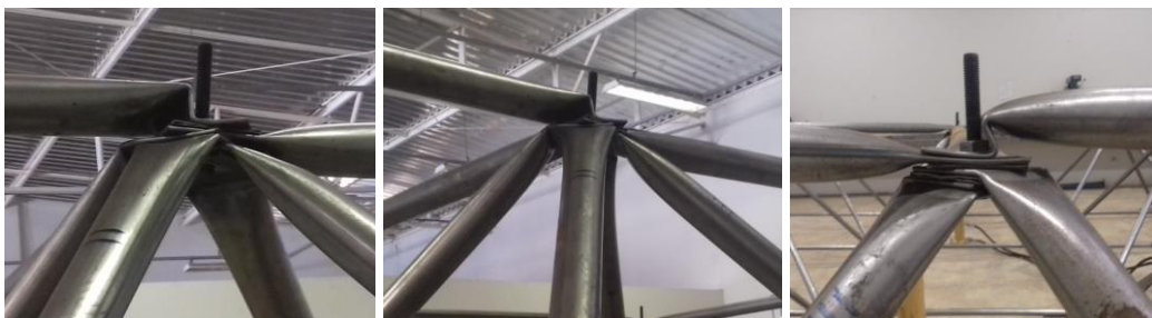
(b) Detalhe do colapso na ligação central na extremidade do protótipo LTI2
