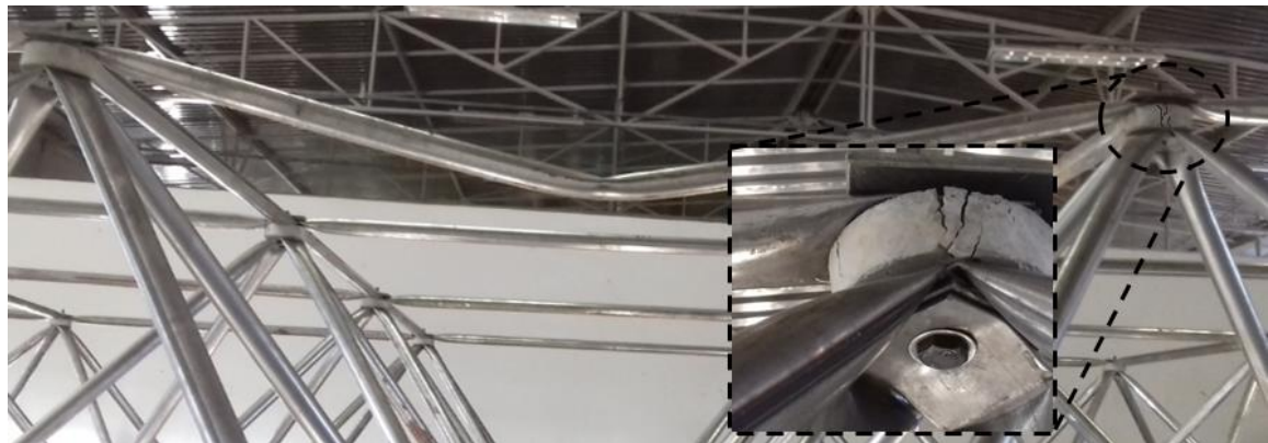
(g) Detalhe do colapso da estrutura na barra comprimida por instabilidade
