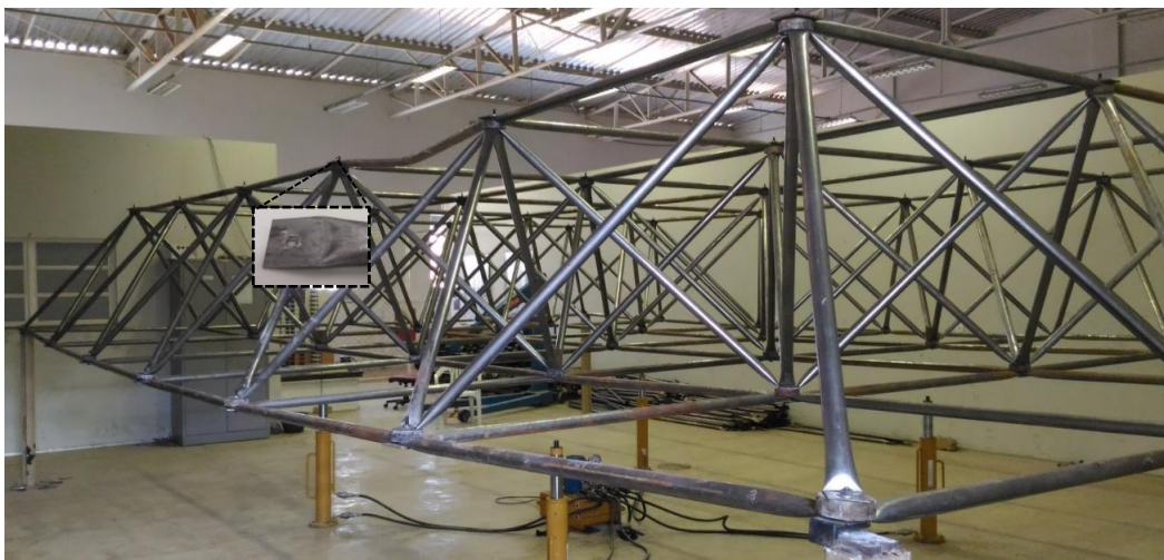
(b) Colapso do protótipo LTDFV2 com detalhe da extremidade da barra que rompeu
