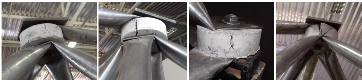
(h) Ruptura do distanciador de concreto após realização do ensaio experimental
