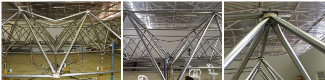
(c) Modos de ruptura do protótipo LTDFS2 em diferentes posições da treliça
