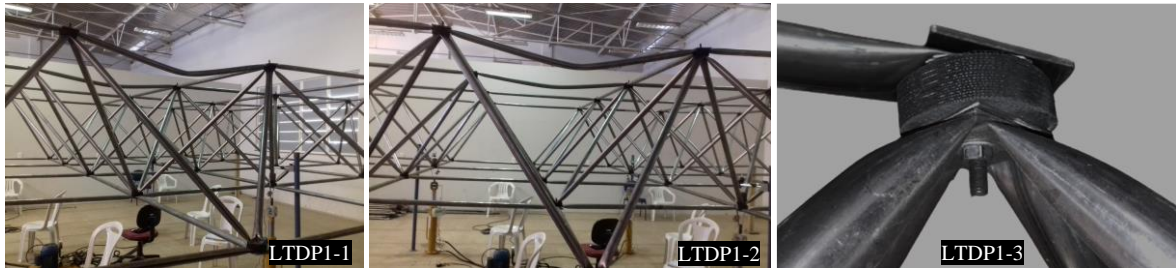
(a) Colapso do primeiro protótipo LTDP1
