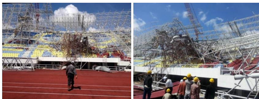
Figura 1.20 – Colapso da estrutura do “ Shah Alam Stadium ” na montagem (Kaos Jr, 2013)
