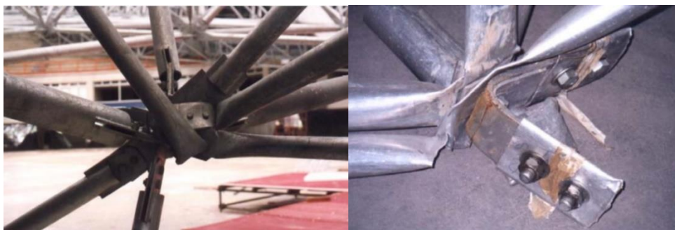
Figura 1.29 – Detalhe do colapso da ligação típica no aeroporto internacional de Belém (Freitas, 2008)
