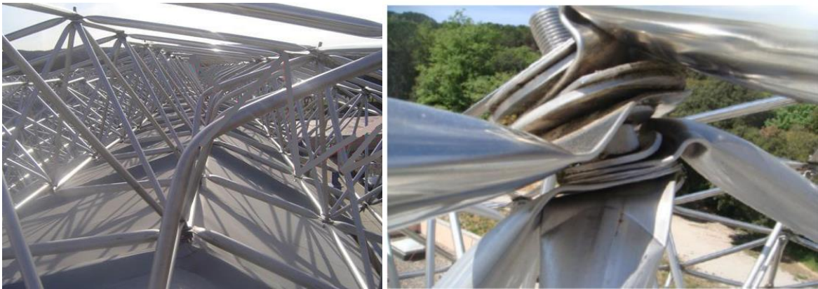
Figura 1.16 – Detalhe da Ligação da treliça tridimensional após o colapso. (Alegre, Ródenas e Villalba, 2012)
