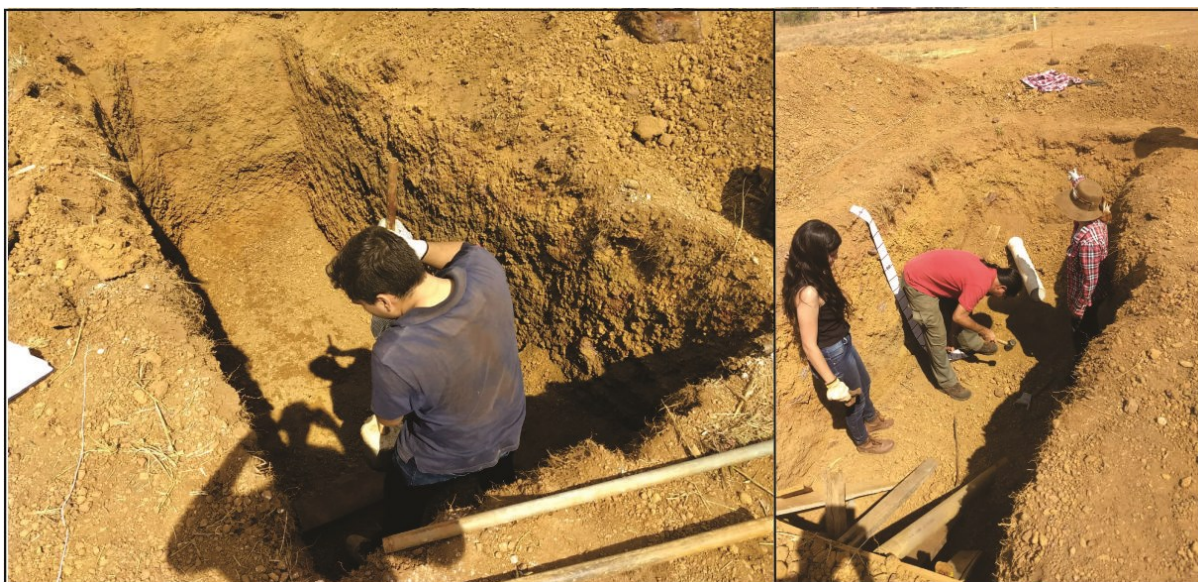
Figura 4.2 Fotos evidenciam as escavações realizadas no campus da UEG (Anápolis, GO) para instalação dos alvos geotécnicos.
