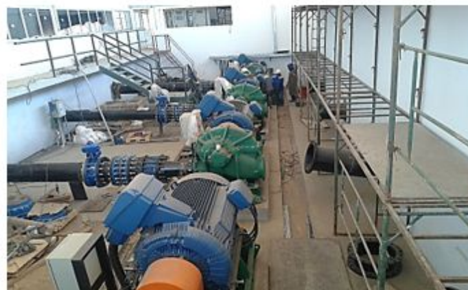
Elevatória de Água Bruta – EAB-RB2 do Ribeirão Bananal.
