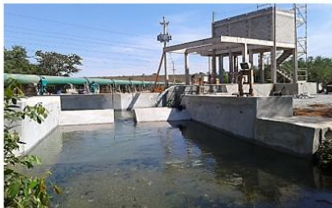
Elevatória de Água Bruta – EAB-RB1 do Ribeirão Bananal.
