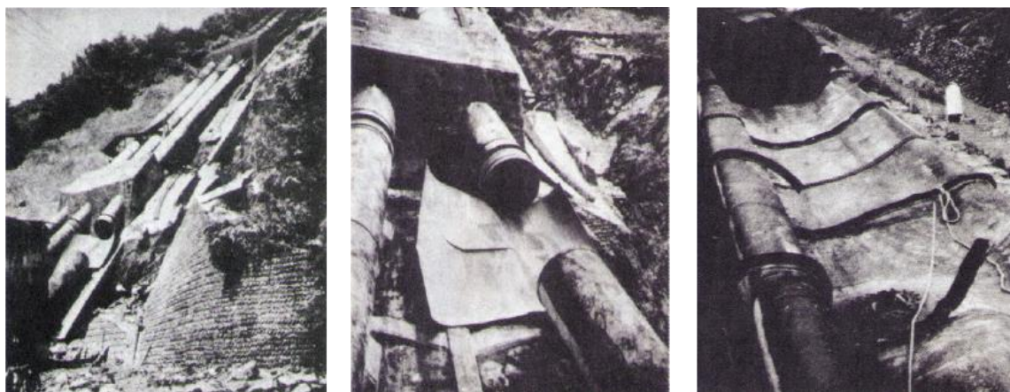
Figura 3.1 – Ruptura e colapso do sistema de tubulações da Central Elétrica de Oigawa, Japão (1950) (Bonin, 1960)
