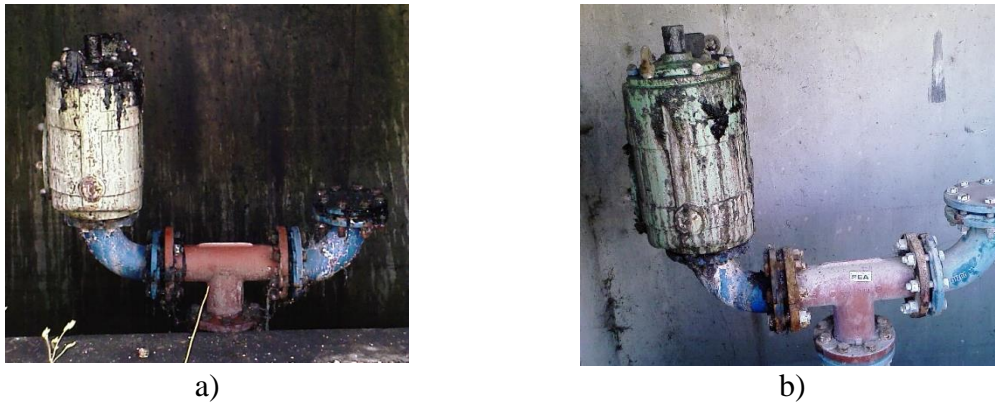
Figura 6.2 – Ventosas instaladas na linha de recalque do Saldanha
