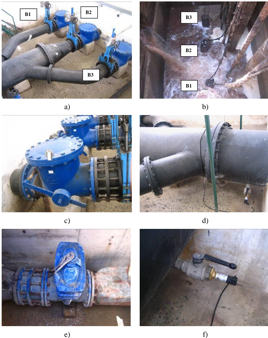
Figura 6.1 – Estação elevatória de esgotos: (a) linhas de compressão, válvulas de gaveta (motorizadas) e válvulas de retenção; (b) poço de sucção e bombas submersíveis; (c) válvula de retenção; (d) transdutor de pressão na linha de recalque; (e) válvula de gaveta e válvula de retenção do by-pass; (f) transdutor de pressão (Soares e Covas, 2015).
