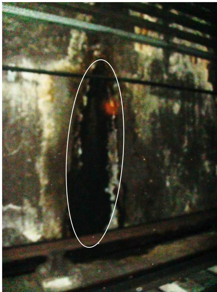
Figura 2.4 – Identificação externa da infiltração na parede do túnel (Fonte: CDC Engenharia – Estudos Geofísicos Aplicados a Geotecnia e a Estruturas de Concreto - 2011)
