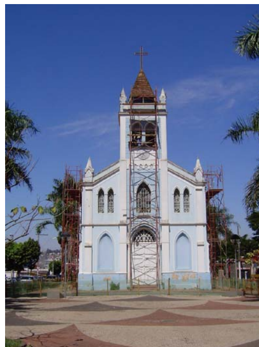
Figuras 46 e 47 – Igreja Nossa Senhora do Rosário (Fundinho), durante obra de recuperação do telhado (agosto de 2004)
