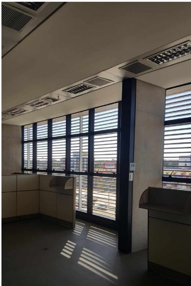
Figura 4-42 – Detalhe do interior do edifício em abril de 2018. Fonte: Câmara dos Deputados (2018).
