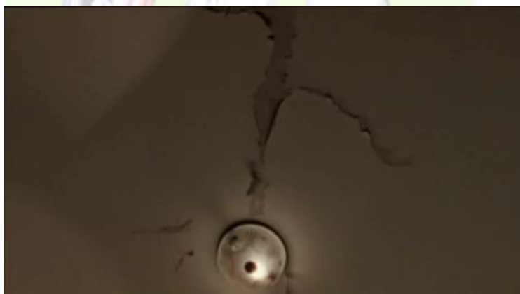
Figura 54. Fotograma da 2ª rachadura que aparece em Cabra-cega
