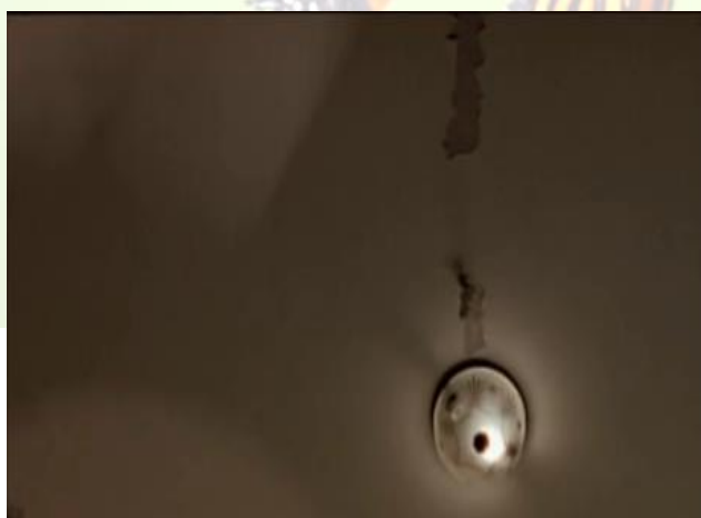
Figura 53. 1ª rachadura indicadora do tempo em Cabra-cega
