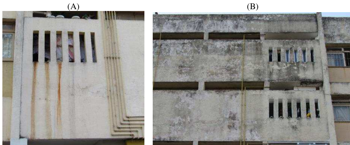
Figura 3.5 – Principais tipos de manchas em fachadas: (A) sujidade; (B) umidade
