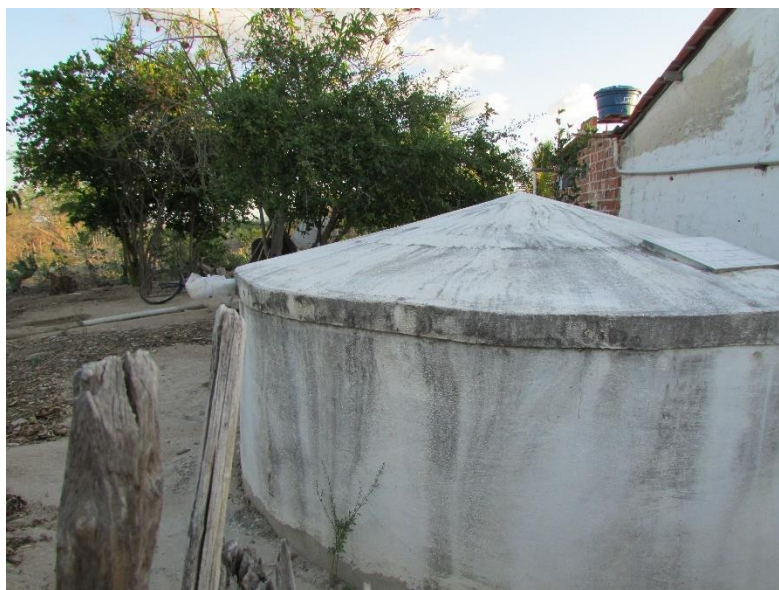
Figura 10 - Cisterna no quintal em Laje das Aroeiras, no município de Uauá
