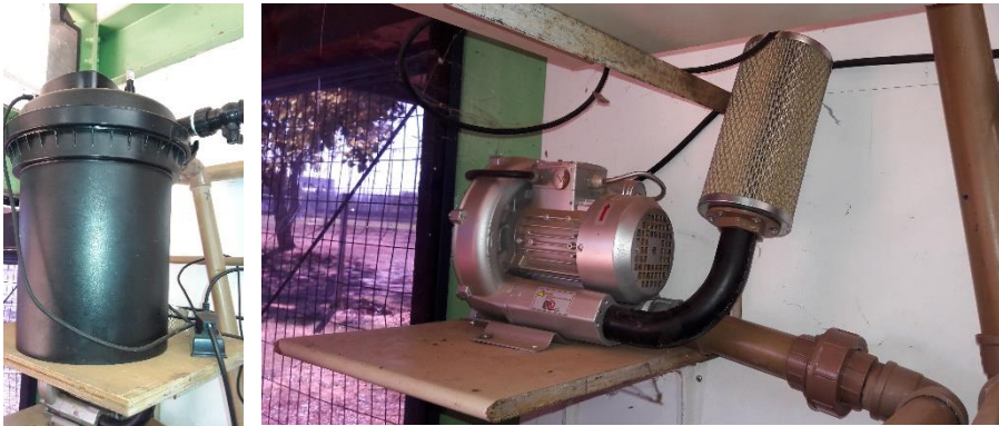
Figura 2. Filtro de lago e soprador de ar.
