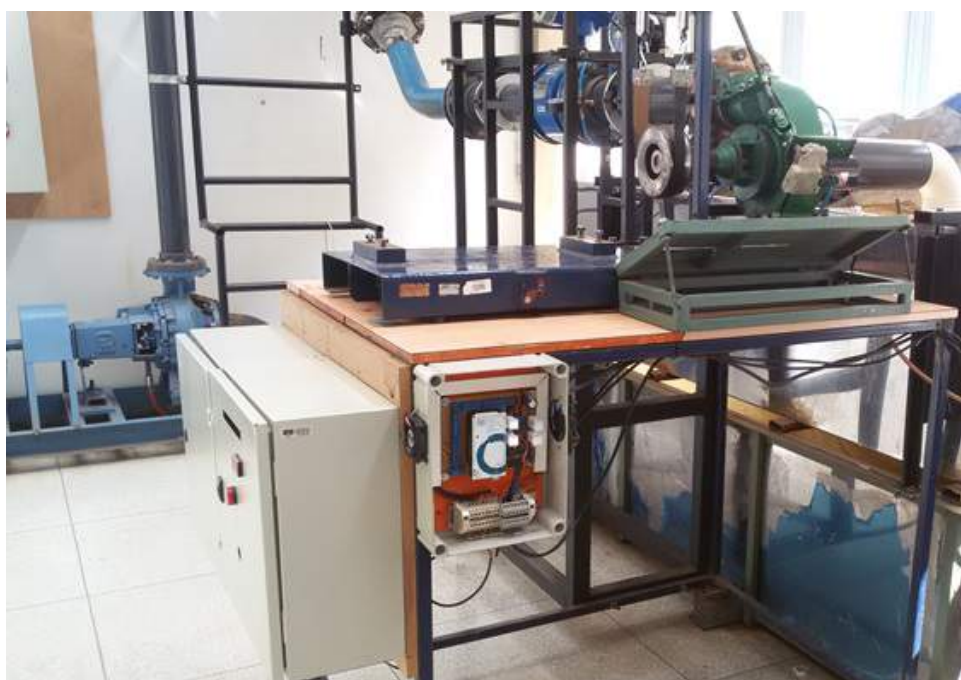
Figura 89 – Disposição final do quadro de comando do projeto - Quadro aberto.
