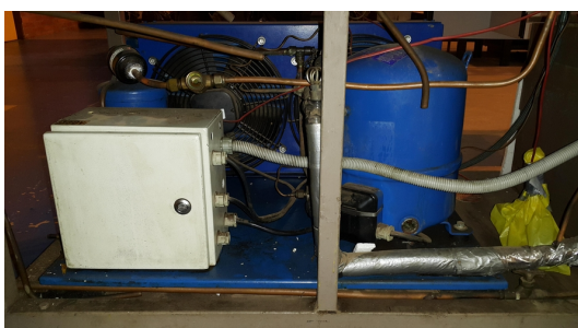
Figura 35 – Compressor e outros componentes
