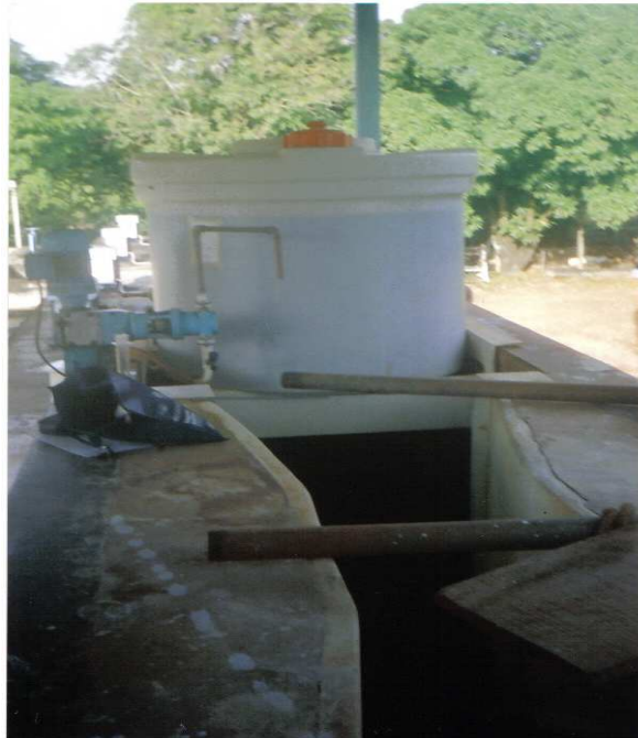
Figura 19 – Chegada da água “crua” – Coagulação
