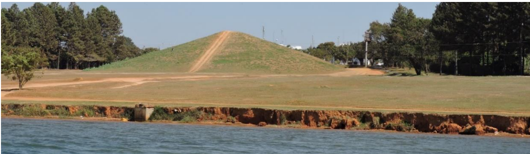
Figura 307: Processos erosivos no Parque do Anfiteatro Natural do Lago Sul.
