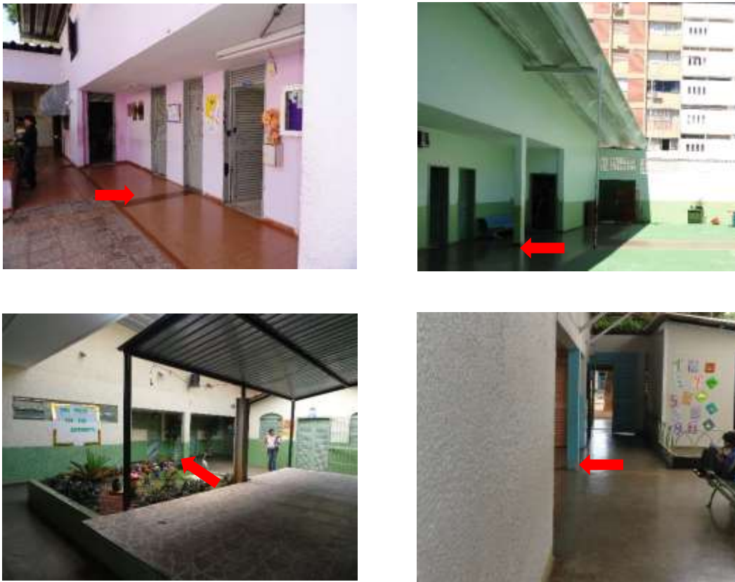
Figura 4.71 – Supressão da parede do hall de entrada no CEF 104 Norte, EC 312 Norte, EC 03 de Brazlândia e EC 05 do Guar4
