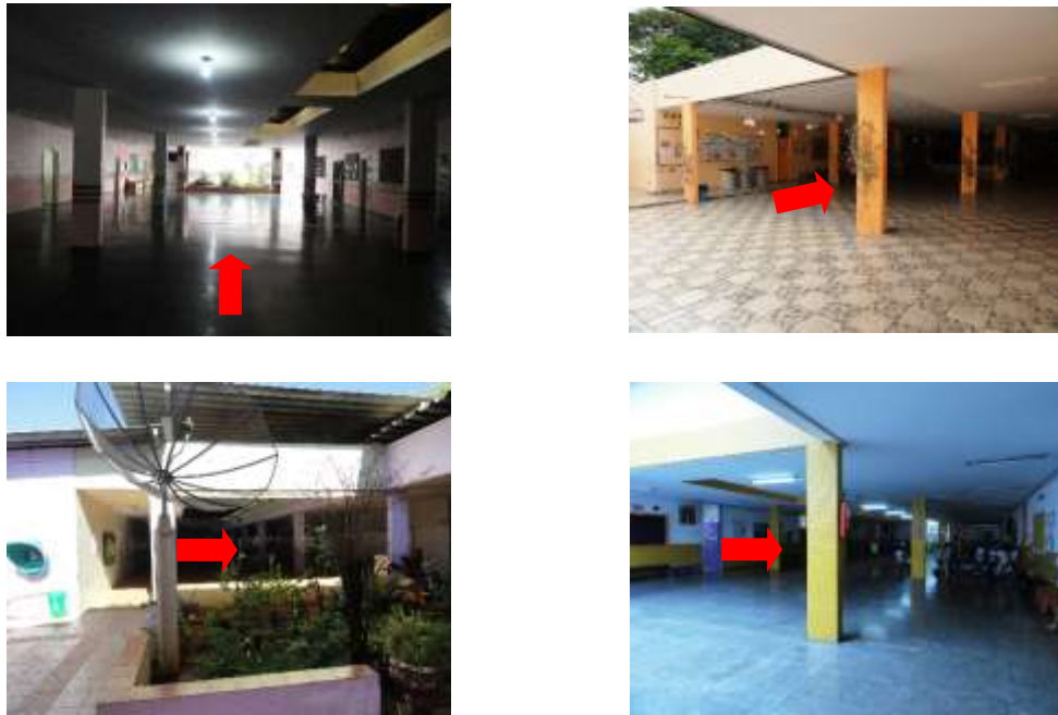
Figura 4.72 – Pátios centrais cobertos na EC 410 Sul, EC 204 Sul, EC 104 Norte e EC 305 Sul.
