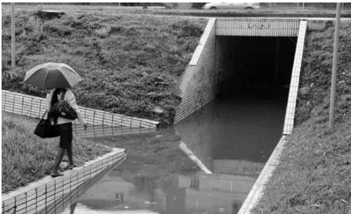
Figura 27. Passagem subterrânea sem drenagem adequada
