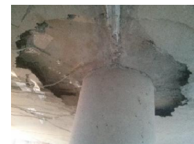
Vista inferior da laje após a ruptura
