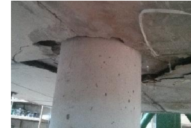
Vista inferior da laje após a ruptura
