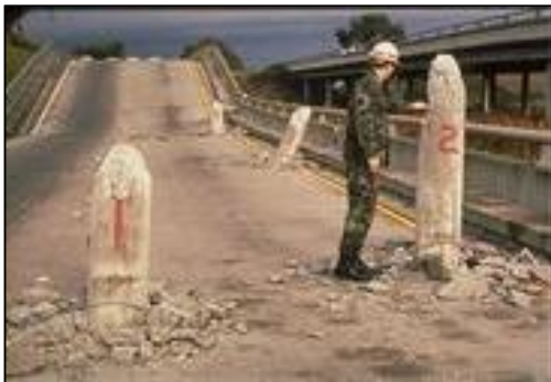
c) Colapso em ponto em Santa Cruz Country, Estados Unidos
