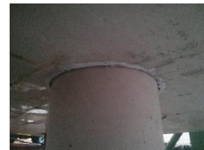
Vista inferior da laje após a ruptura
