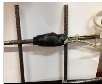
f) Proteção mecânica com fita isolante de auto-fusão
