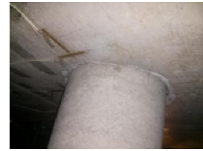
Vista inferior da laje após a ruptura
