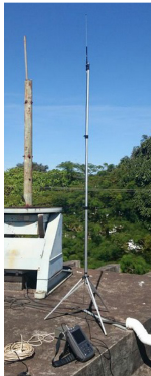
Figura 4.13: Sistema de transmissão
