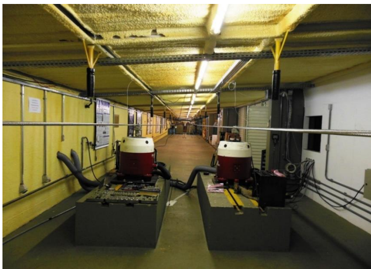
Figura 5 - Bloco fixo com trilho para deslocamento do shaker .
