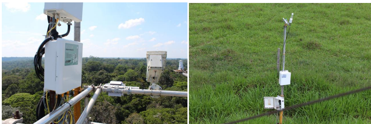
Figura III-19. Analisador de gás infravermelho, instalados nas torres K34 e FNS.
