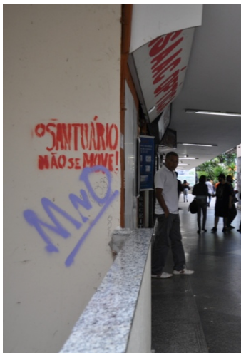
Fig. 60- Estêncil feito na fachada do Ed. Miguel Badya – 2012 Foto: Rogério Rezende
