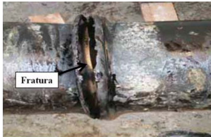
Figura 2.8 Seção do duto PE-II com fratura causada por flambagem local de parede. (Cardoso, 2005).
