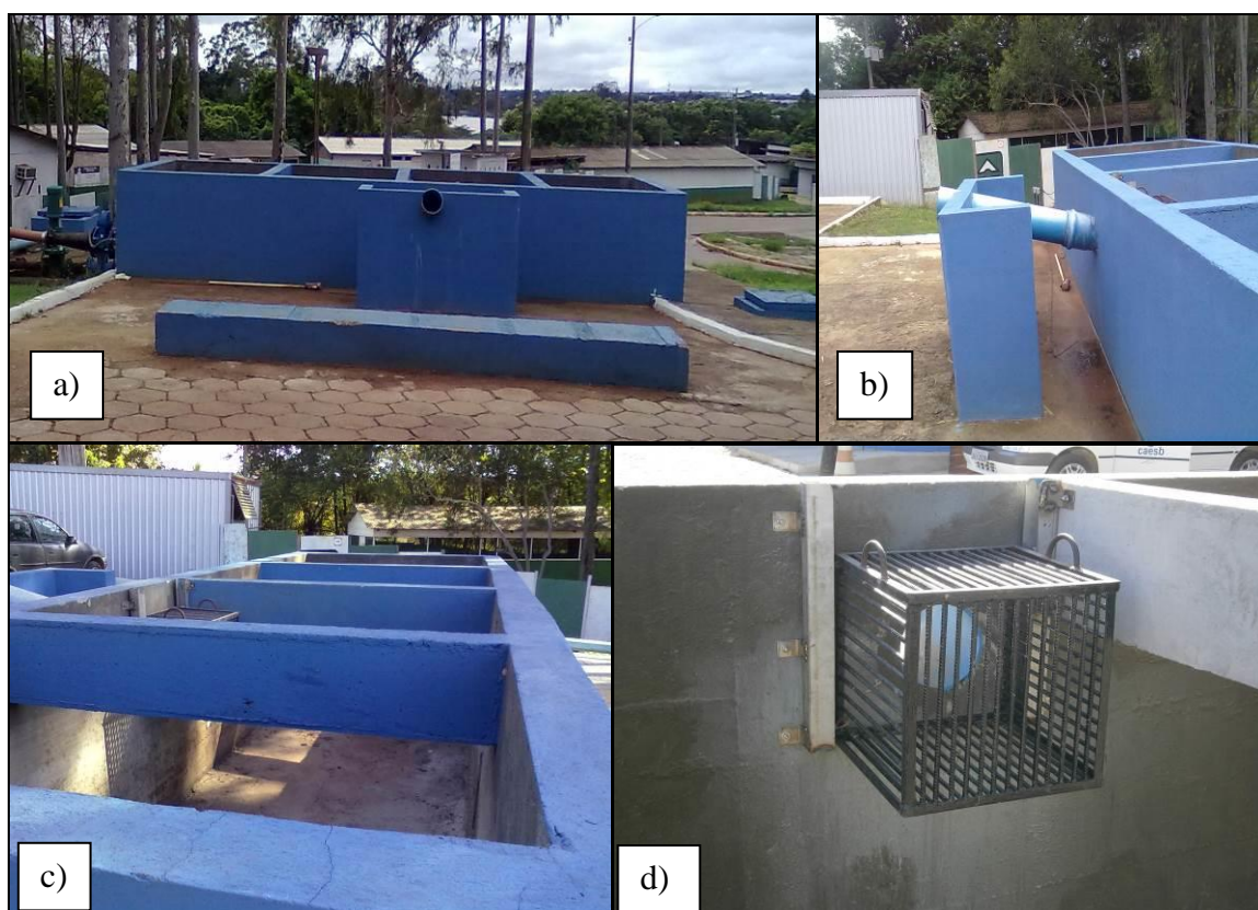
Figura 4.4 - a) Vista de frente do tanque equalizador; b) Detalhe da entrada do tanque, acesso para os mangotes dos caminhões; c) Vista de dentro do tanque; d) Gradeamento na entrada do tanque.
