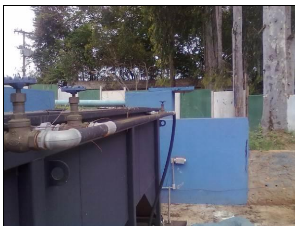
Figura 5.10 - Entradas do sistema aeração da Unidade Central.
