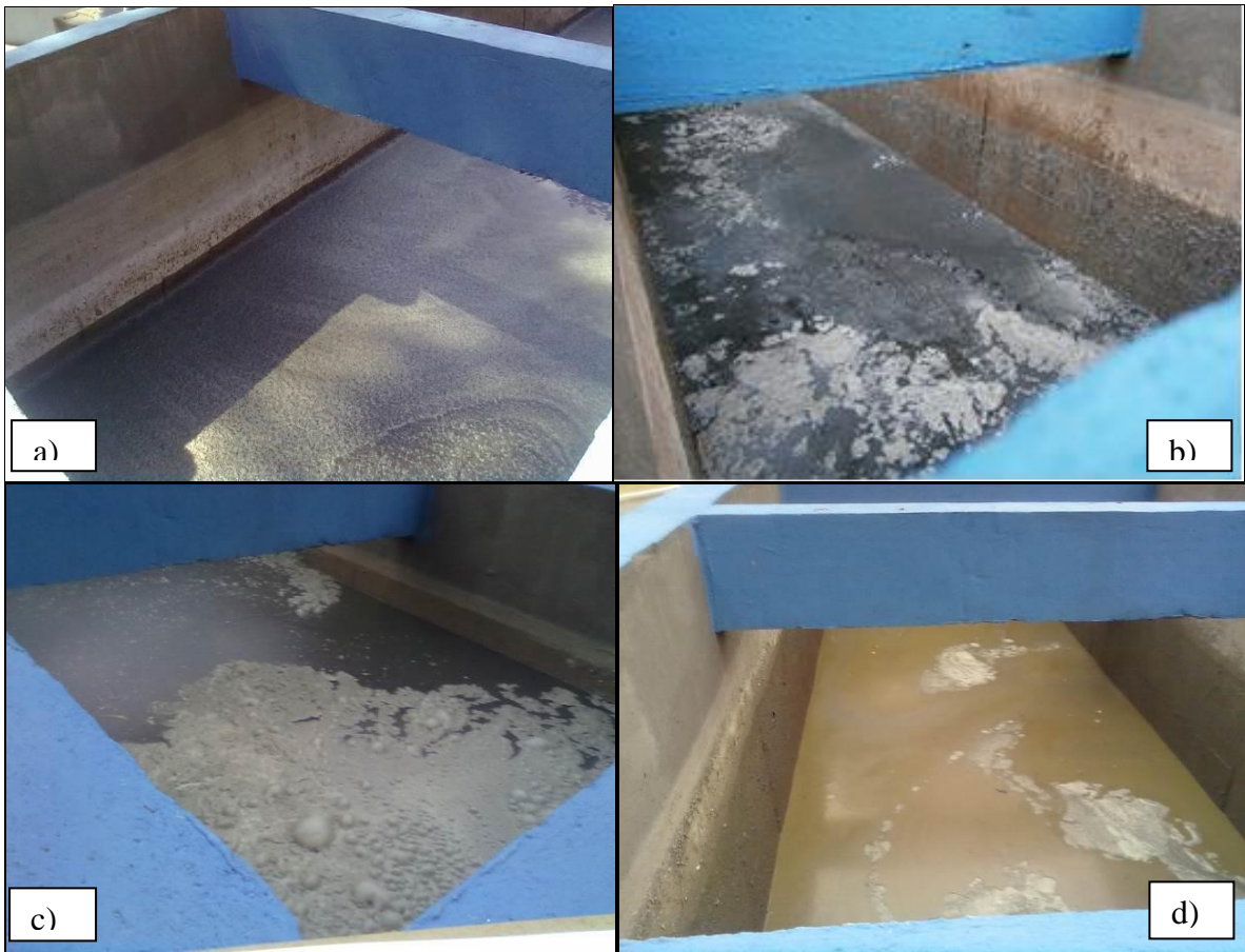
Figura G.3 - a) Tanque equalizador com lodo de fossa oriundo de uma lavanderia; b) Acúmulo de resíduos no fundo do tanque equalizador (somente lodos de fossas); c e d) Tanque equalizador recebendo resíduos gordurosos e lodos de fossas.
