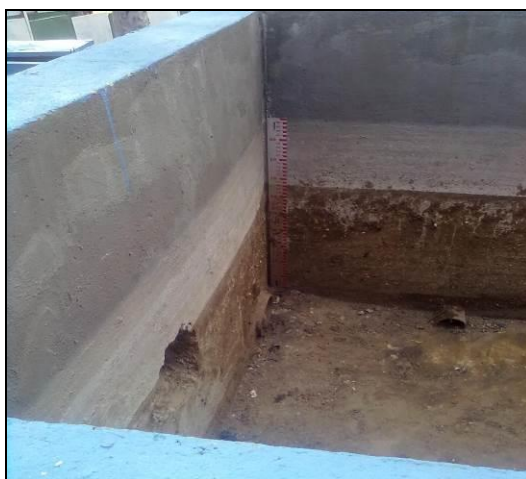
Figura 5.12 - Régua milimetrada instalada no tanque equalizador.
