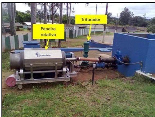
Figura 4.5 -Peneira rotativa e triturador instalados nas saídas do tanque equalizador.
