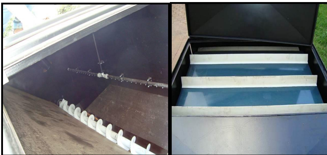
Figura 4.7 – Vista superior o transportador helicoidal e parte do sistema de aeração (à esquerda) e raspador superficial da Unidade Central (à direita).
