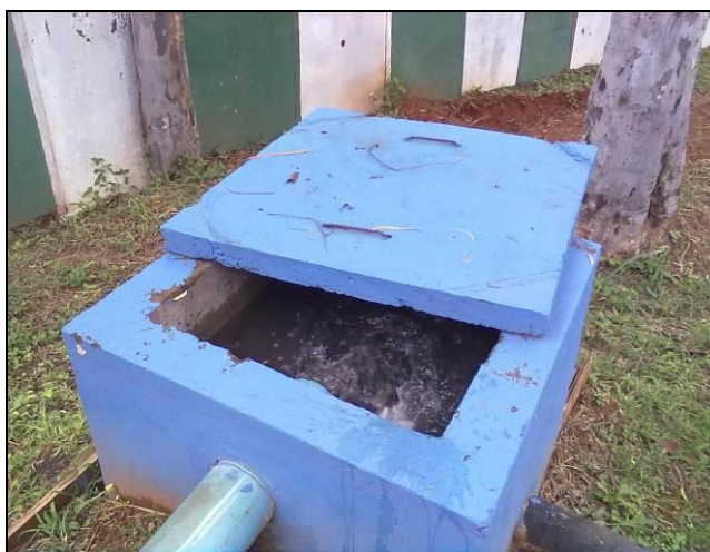
Figura 5.8 – Redemoinho formado na caixa de passagem 2.
