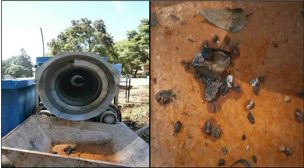
Figura 5.6 - Peneira rotativa em funcionamento (à esquerda) e material sólido após passar pela peneira (à direita).
