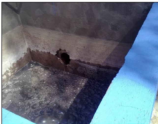
Figura 5.5 - Vista da saída do tanque equalizador que dá acesso a peneira rotativa.
