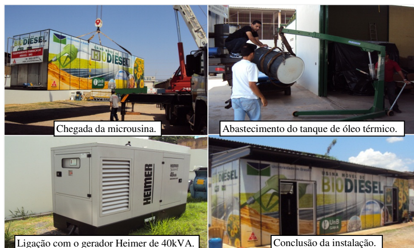
Figura A.5 - Instalação da Microusina de Produção de Biodiesel UnB/FGA.
