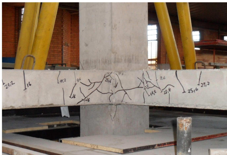
Figura 4.83 – Aspecto das fissuras na reentrância da laje LR01
