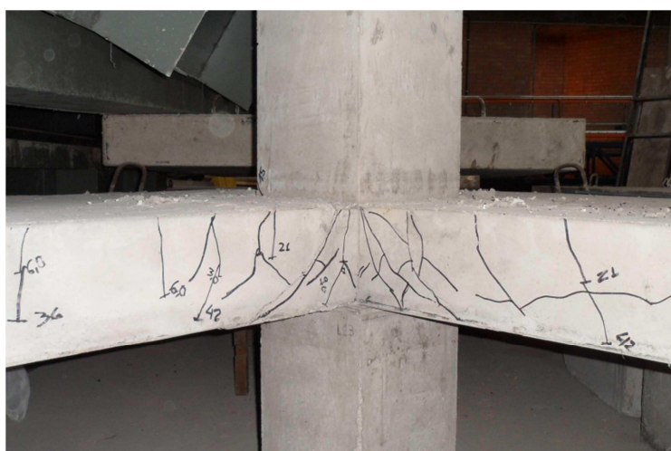
Figura 4.85 - Aspecto das fissuras na reentrância da laje LC03
