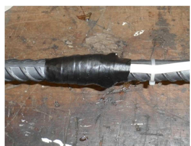
(f) Proteção mecânica com fita isolante de auto-fusão
