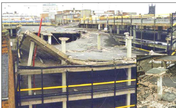
Figura 1.2 - Colapso parcial do edifício Pipers Row Car Park, Wolverhampton (1997)
