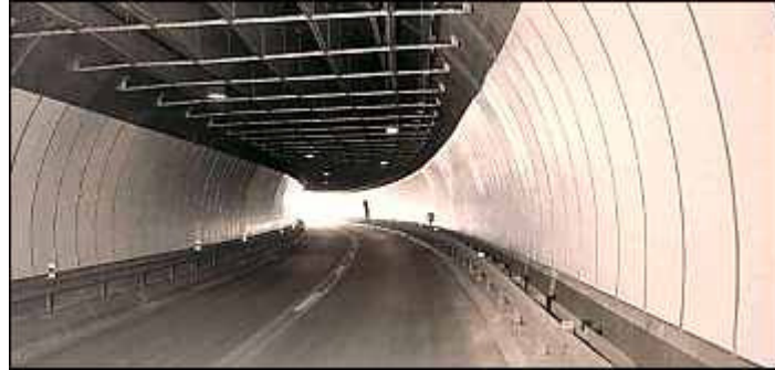
Figura 5.11 – Painéis no Interior de um Túnel.
