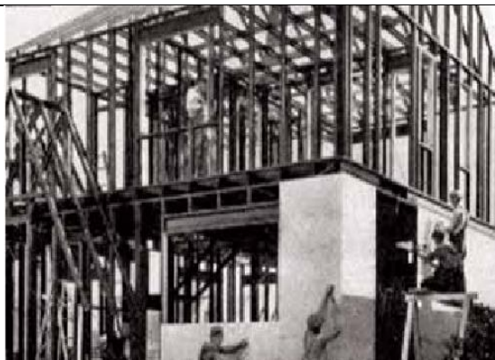
Figura 2. 32 – Protótipo de residência em Light Steel Framing na Exposição Mundial de Chicago em 1933 (HTTP://webpages.marshall.edu/~brooks/STRAN/stran 1.htm)
