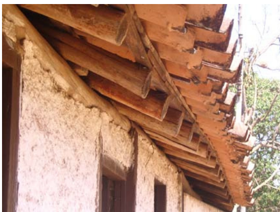
Fachada 252 – Detalhe da estrutura do telhado em madeira com telhas de barro (Acervo PROAU/FAU/UnB).
