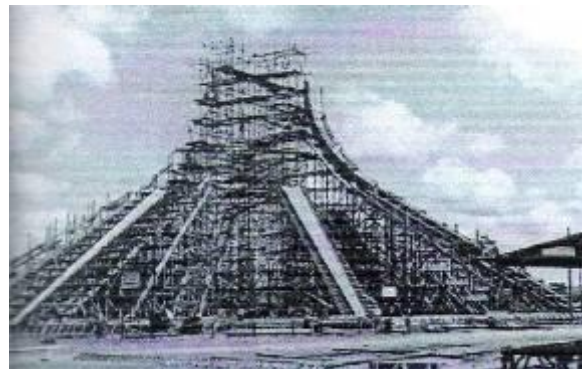
Figura 5.13. Escoramento dos Pilares da Catedral de Brasília. Fonte: Magalhães, 1959 apud PESSOA, 2002, p. 18.
