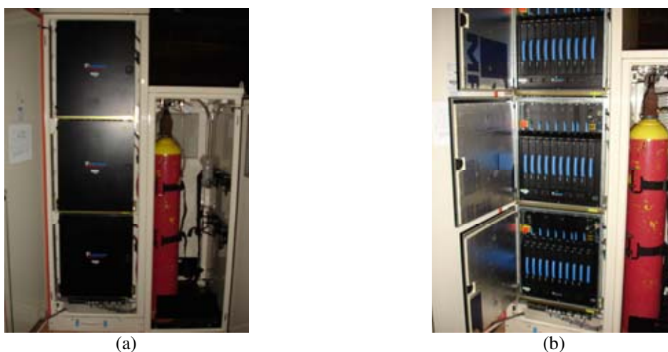
Figura 4.21 CaC T-2000 6 kW: (a) vista frontal com gabinetes fechados; (b) vista frontal com um gabinete aberto.
