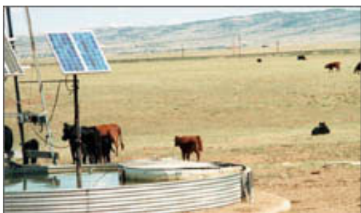
Figura 3.4 Sistema para bombeamento de água.
