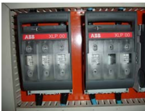
Figura 4.33 Galpão do SHGD: (a) novo quadro de seccionamento e proteção que alimenta o Quadro CC e banco de baterias do Sistema 1; (b) detalhe interno do quadro.
