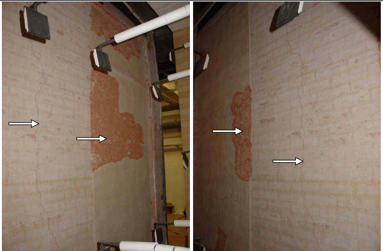
Fig. 64 – Fissura vertical no centro da parede, face exposta ao fogo. Detalhe dos descolamentos de parte das duas faixas laterais de reboco.
