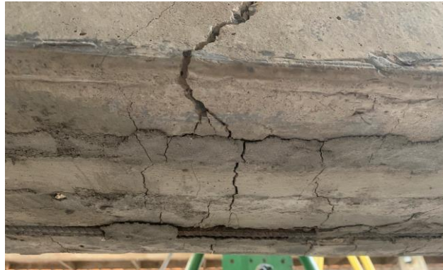
Figura 4.10: Ranhuras da viga VA5 após o ensaio.
