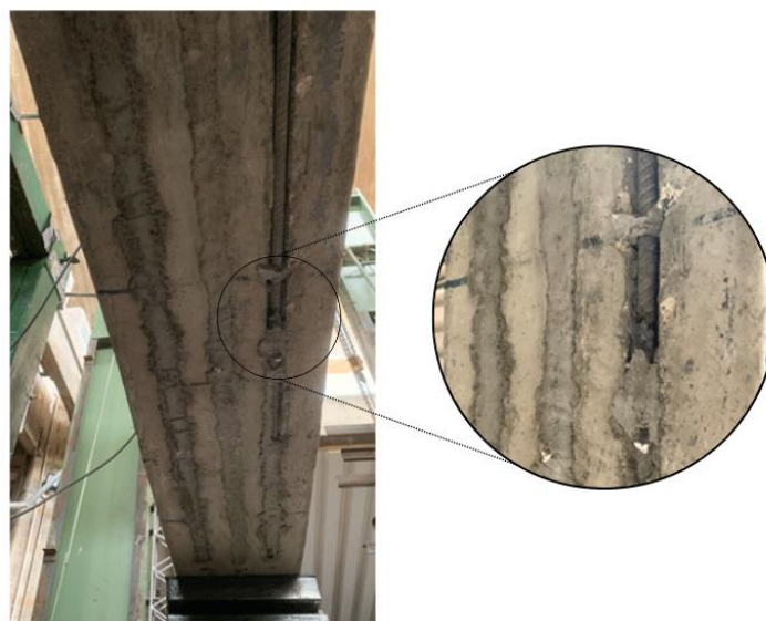
Figura 4.12: Deslocamento da argamassa próximo ao apoio da viga.
