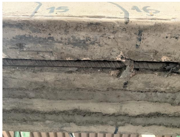
Figura 4.11: Deslocamento da argamassa em regiões sem fissuras.
