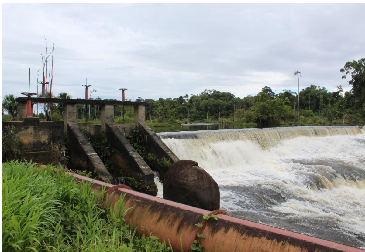
Imagem 9: Barragem de Jandú-Cachoeira no Igarapé Umari, Comunidade de São Sebastião. Com a energia produzida na Mini-Hidrelétrica são abastecidos o 6º Pelotão de Fronteira do Exército e as comunidades de Pari-Cachoeira, São Sebastião e Bela Vista.
