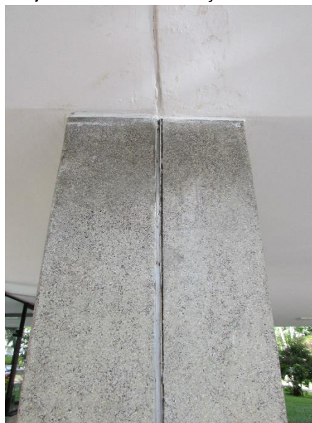
Figura 67 – Ausência de selante de vedação nas juntas de movimentação estrutural.
