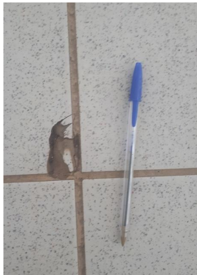
Figura 57 – Dano observado no piso dos halls.
