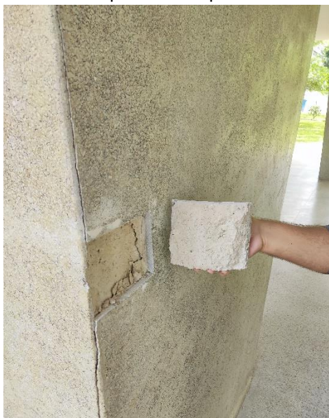
Figura 66 – Destacamento do revestimento da superfície dos pilares.
