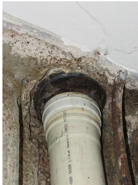
Figura 59 – Junção de tubo pvc em conexão de ferro fundido.
