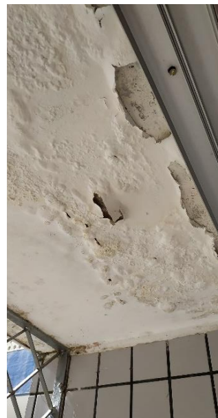
Figura 53 – Empolamento do revestimento interno.
