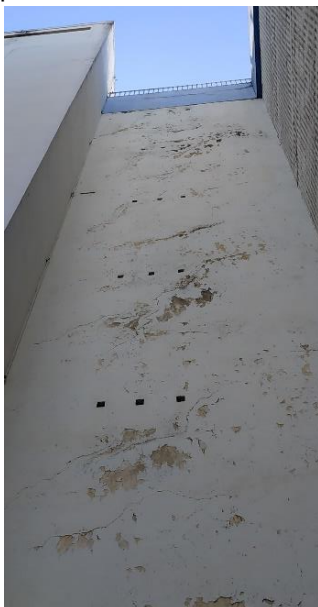
Figura 51 – Degradação da pintura da fachada externa.
