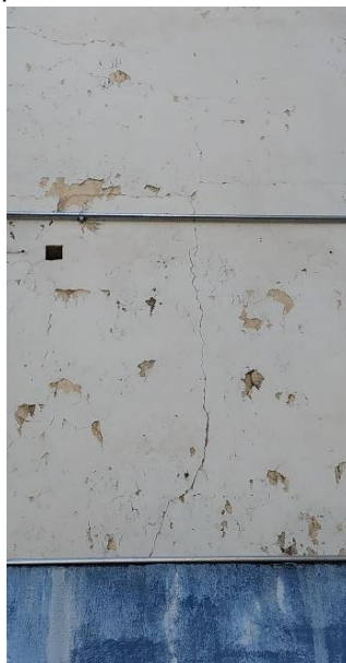
Figura 52 – Degradação da pintura da fachada externa.
