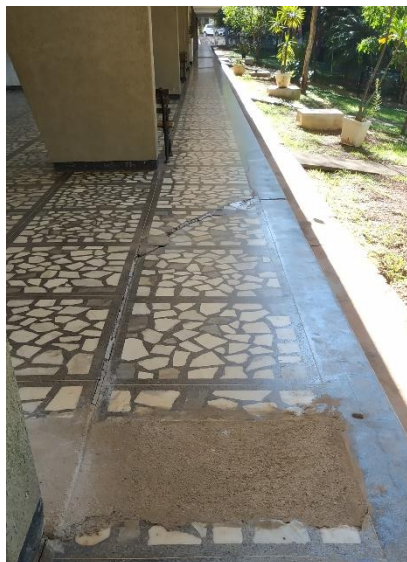
Figura 56 – Danos observados no piso do pilotis.
