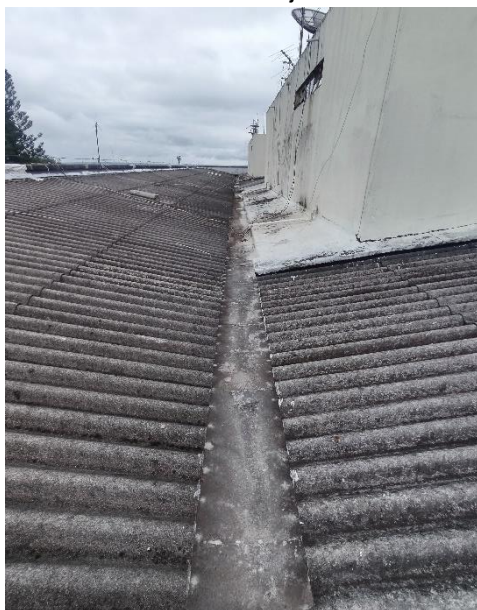
Figura 72 – Telhas desgastadas e com acúmulos de sujidades.
