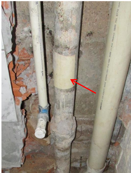
Figura 58 – Paliativo realizado no tubo de ferro fundido utilizando pedaço de tubo pvc.
