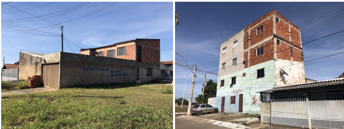
Figura 107 – Obras irregulares nos fundos dos lotes das casas
