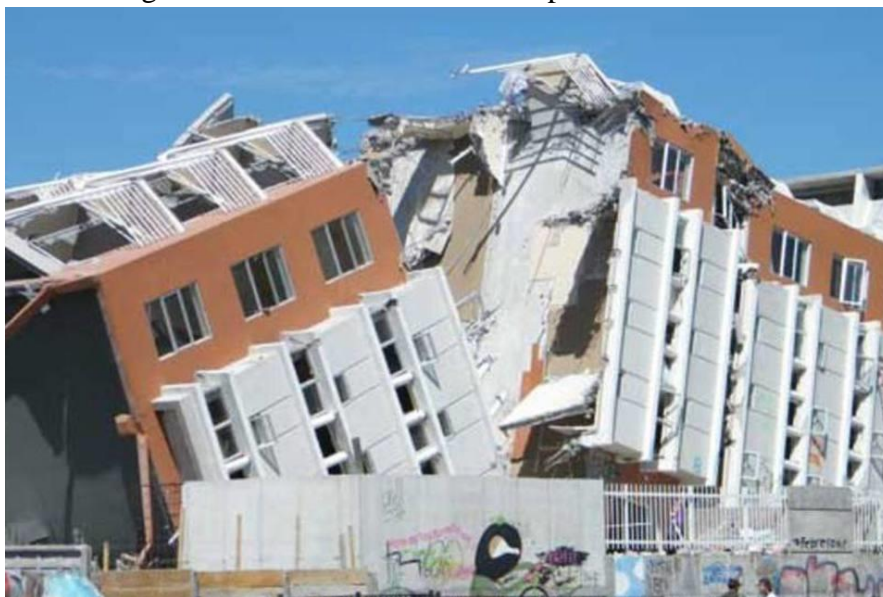
Figura 2 – Estrutura de concreto após abalo sísmico.
