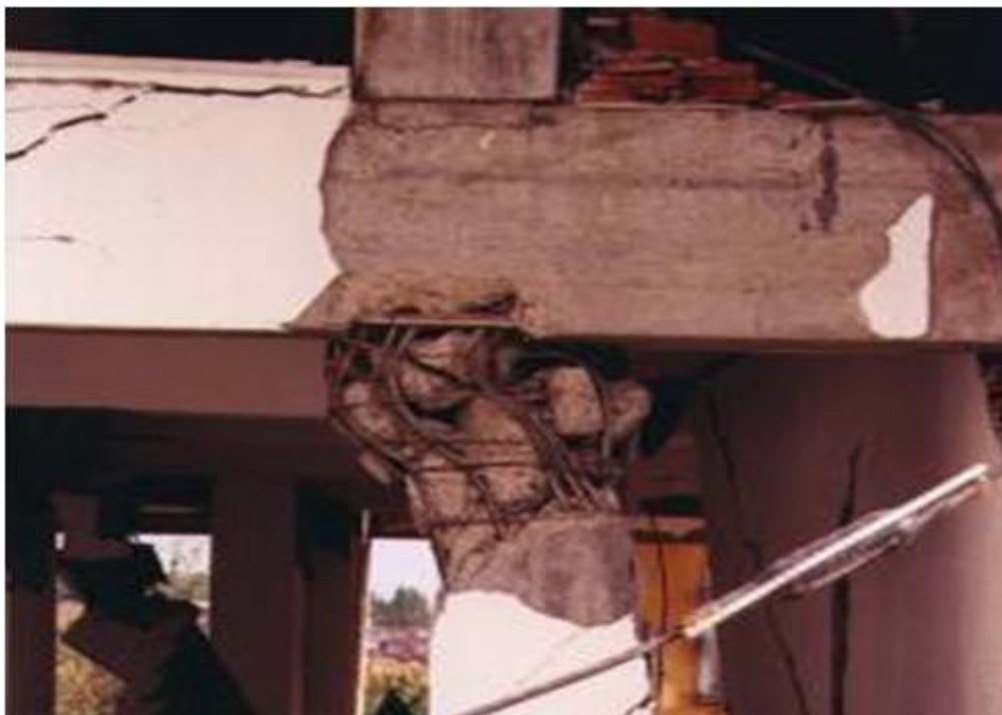
Figura 3 – Estrutura de concreto apos abalo sísmico (Rodrigues: 2006).
