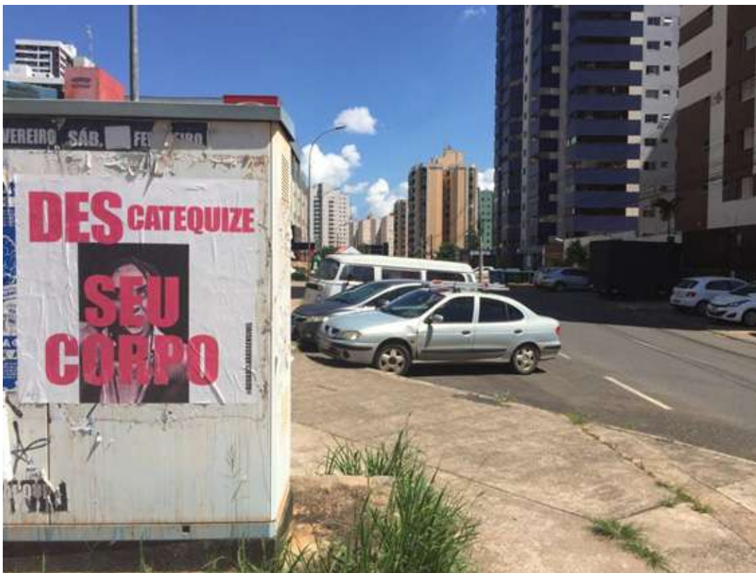
Figura 145 – Lambe na caixa de energia em frente a Avenida das Araucárias, 2020
