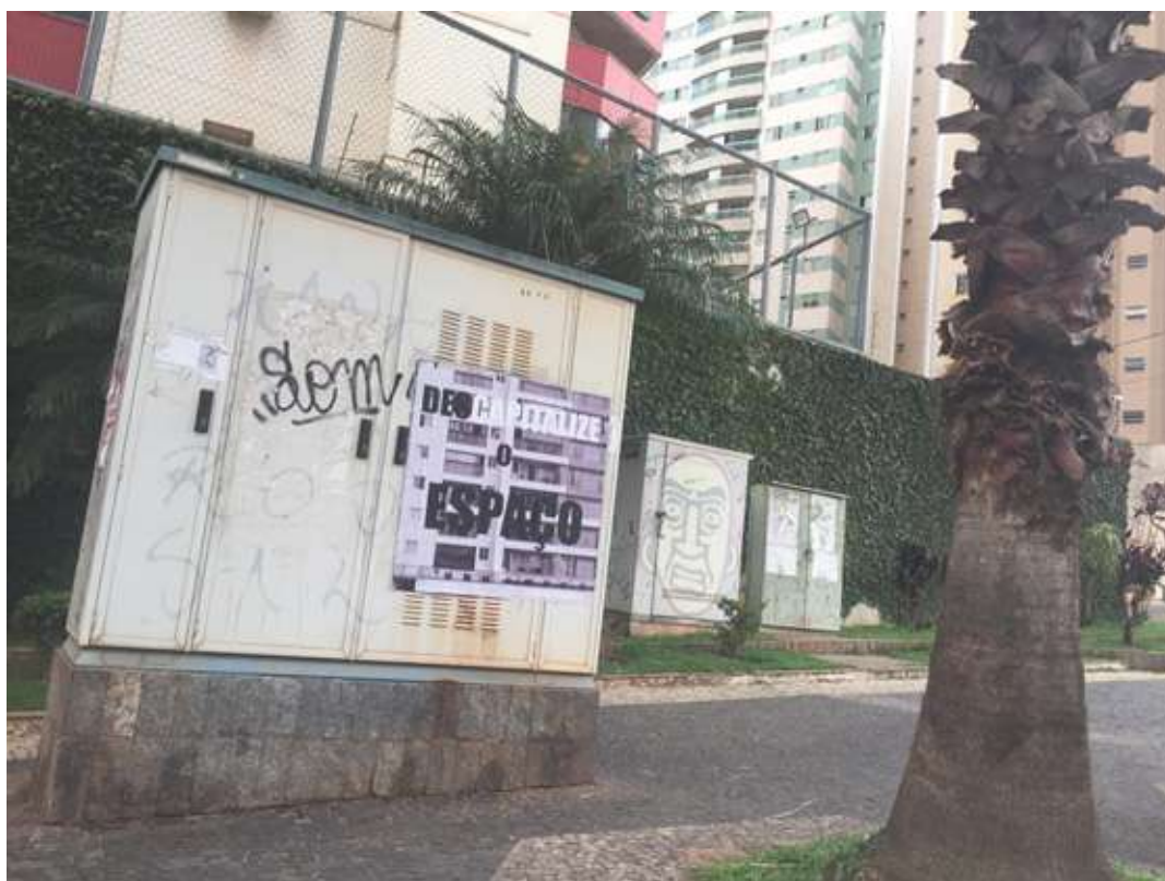
Figura 139 – Lambe grudado na caixa de energia em frente a entrada do Parque de Águas Claras, na Av. Parque de Águas Claras, 2020
