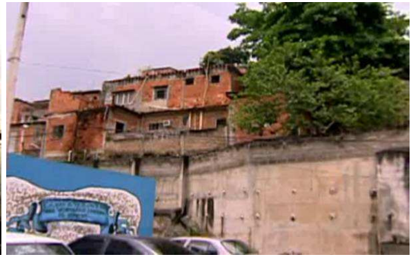
Figura 97 – Favela sobre muro de contenção. Em azul, parte da área do refeitório do CIEP
