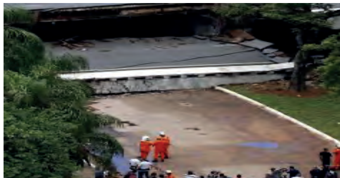
Figura 9: Vista oblíqua da parte precipitada do viaduto.
