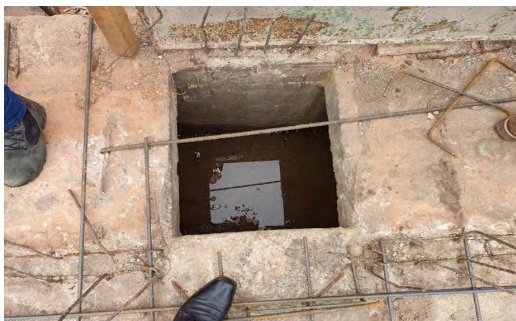
Figura 5: Água acumulada no interior da estrutura mesmo sem chuva.
