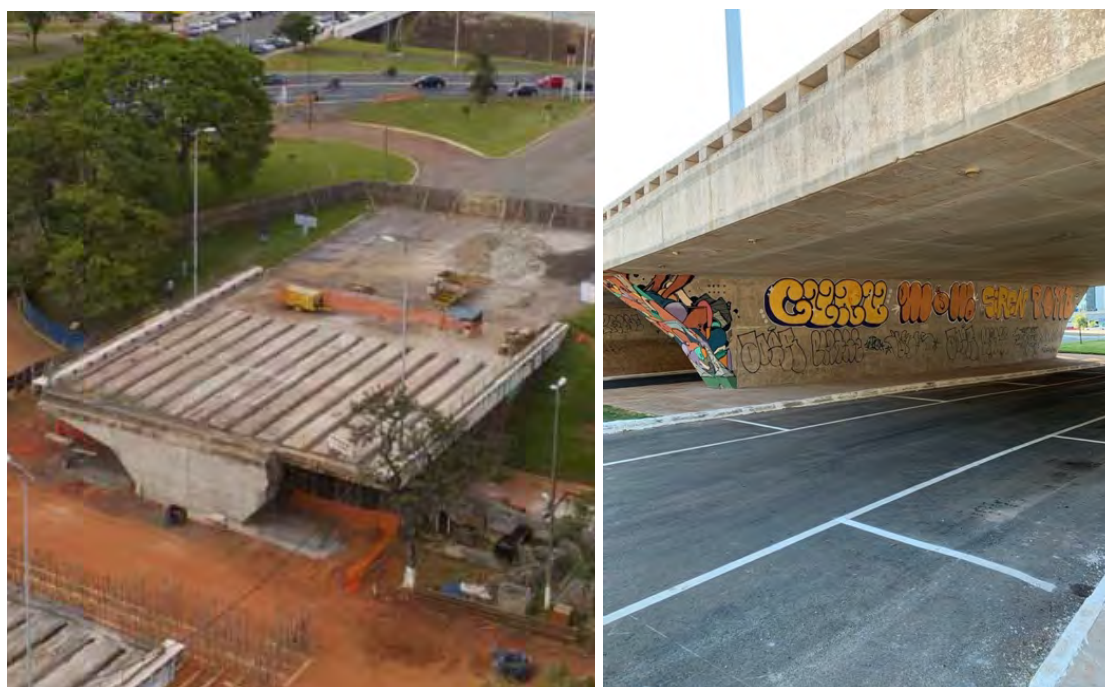
Figura 14 – 15. Pilar em situação de ruína parcial após desabamento e pilar após Retrofit estrutural, Viaduto sobre a Galeria dos Estados, Brasília, DF (Fonte: autora)
