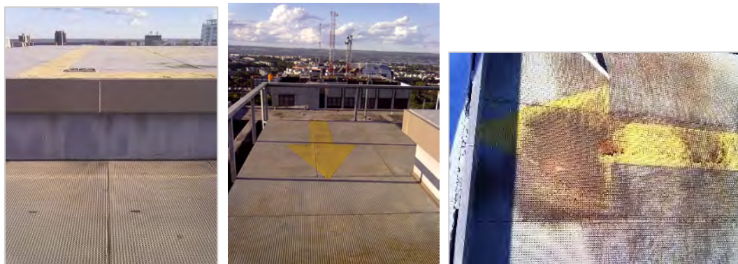
Figuras 7, 8 e 9 – Diferença de altura da FATO para a TLOF e estado precário de manutenção da FATO
