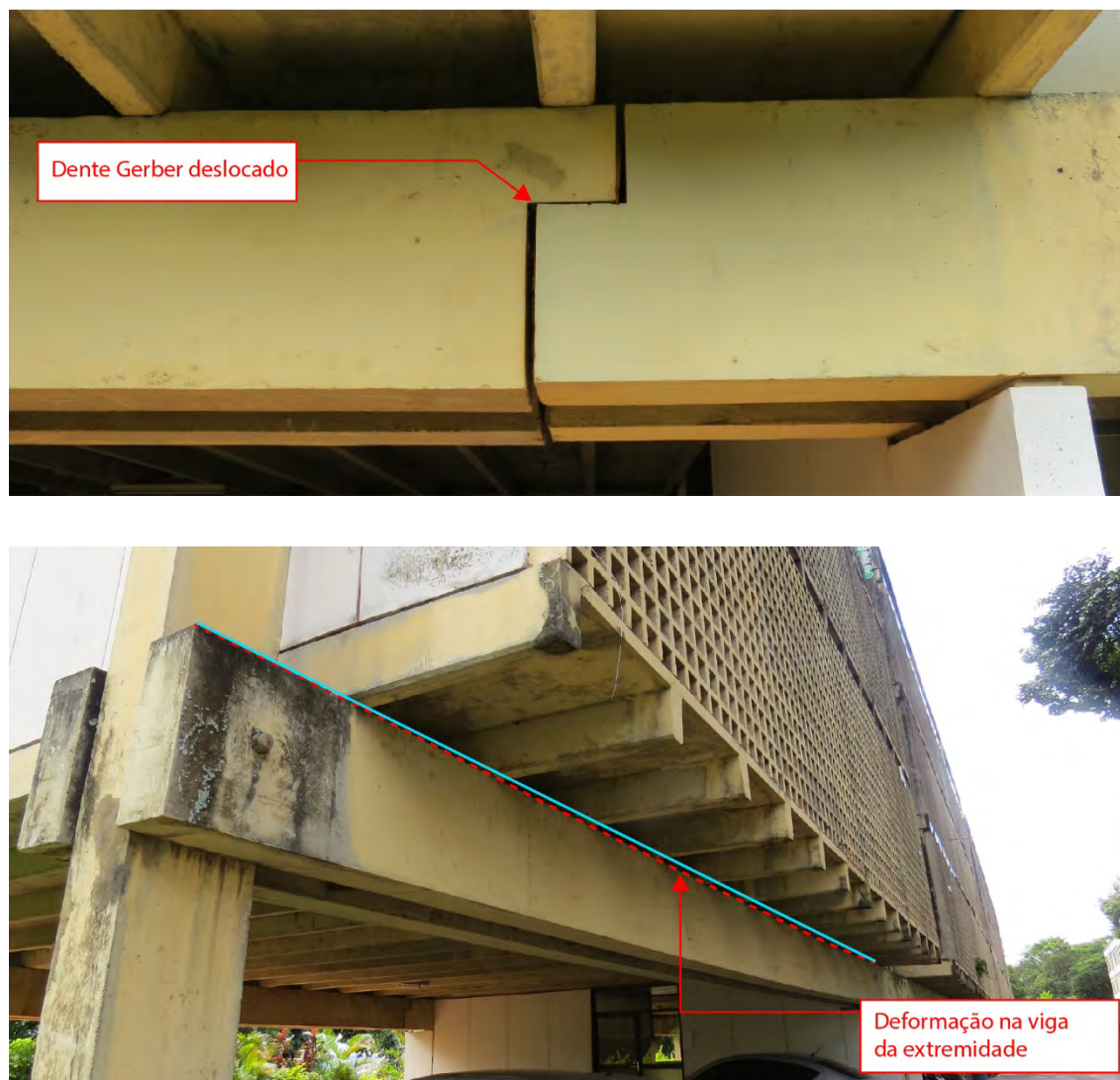
Figura 25 – Inspeção visual. Deslocamento na viga da extremidade. Fonte: Acervo do autor
