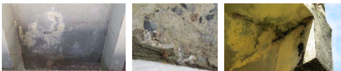
Figura 29 – Eflorescência | Figura 30 – Desagregação | Figura 31 – Fissuras. Fonte: Acervo do Autor
