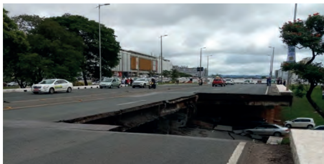
Figura 7: Imagem do momento da queda de partes da estrutura.
