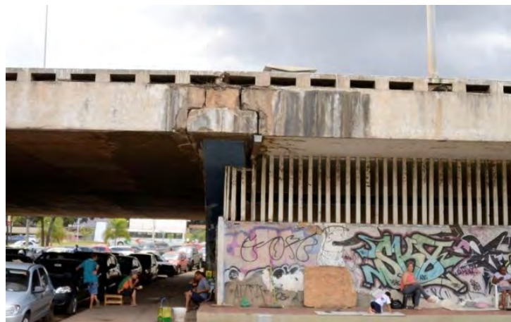
Figura 3: Imagem da estrutura antes do colapso e da atual intervenção.
