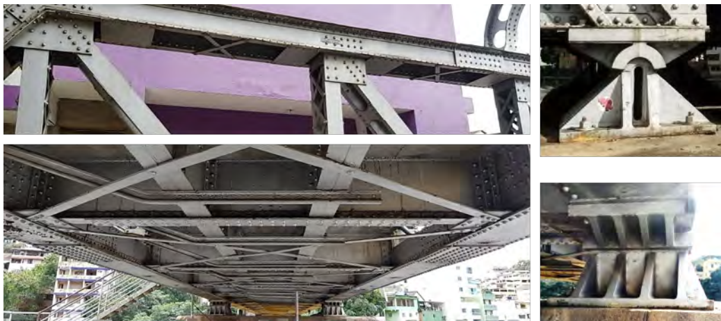
Figura 5: Vista lateral e inferior da estrutura da Ponte de Ferro e dos aparelhos de apoio.
