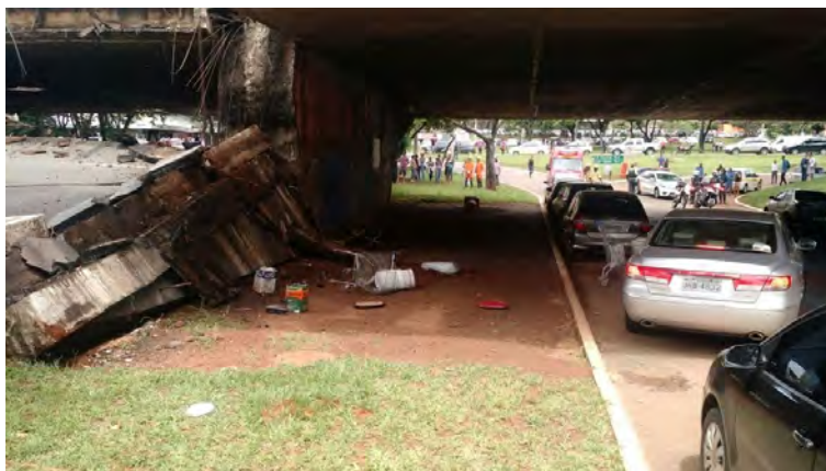
Figura 6: Notar os vestígios de oxidação das ferragens.
