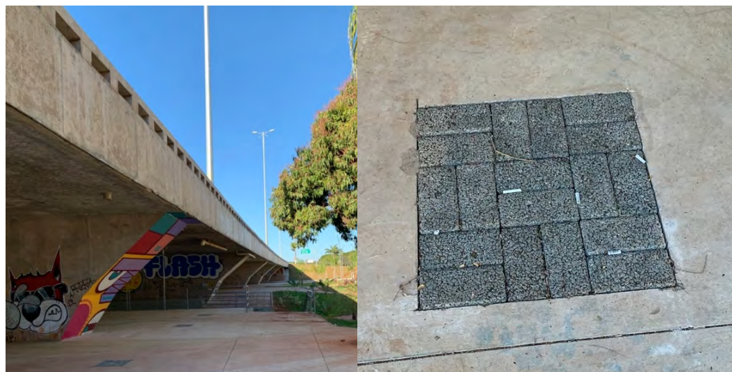
Figura 18. Ponto de escoamento em pavimentação drenante, concreto permeável, Viaduto sobre a Galeria dos Estados, Brasília, DF (Fonte: autoral)
