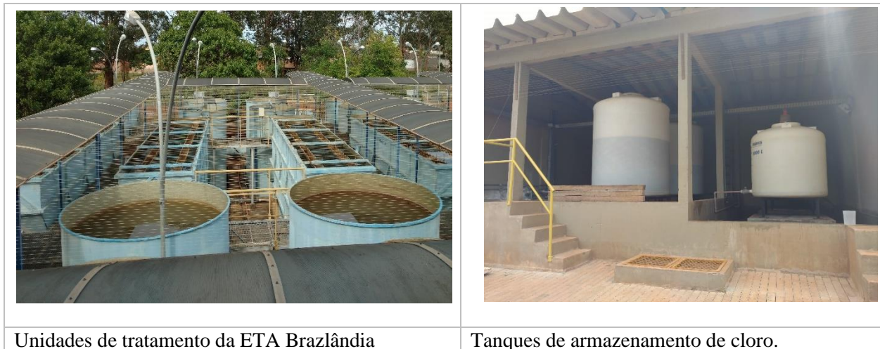
Figura 27 – Imagens ilustrativas da ETA Brazlândia Fonte: Distrito Federal (2017b)
