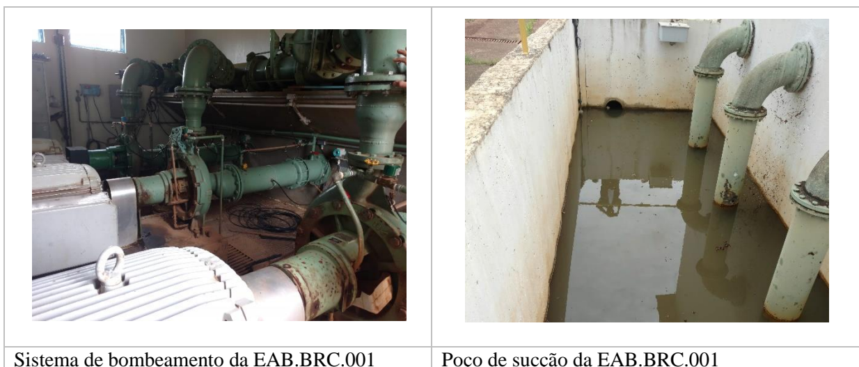
Figura 26 – Estação elevatória de água bruta (EAB.BRC.001) Fonte: Distrito Federal (2017b)
