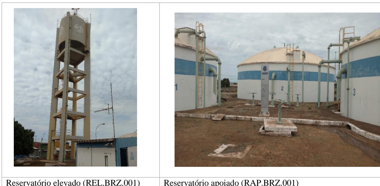
Figura 28 – Reservatórios de água tratada do SAA Brazlândia Fonte: Distrito Federal (2017b)
