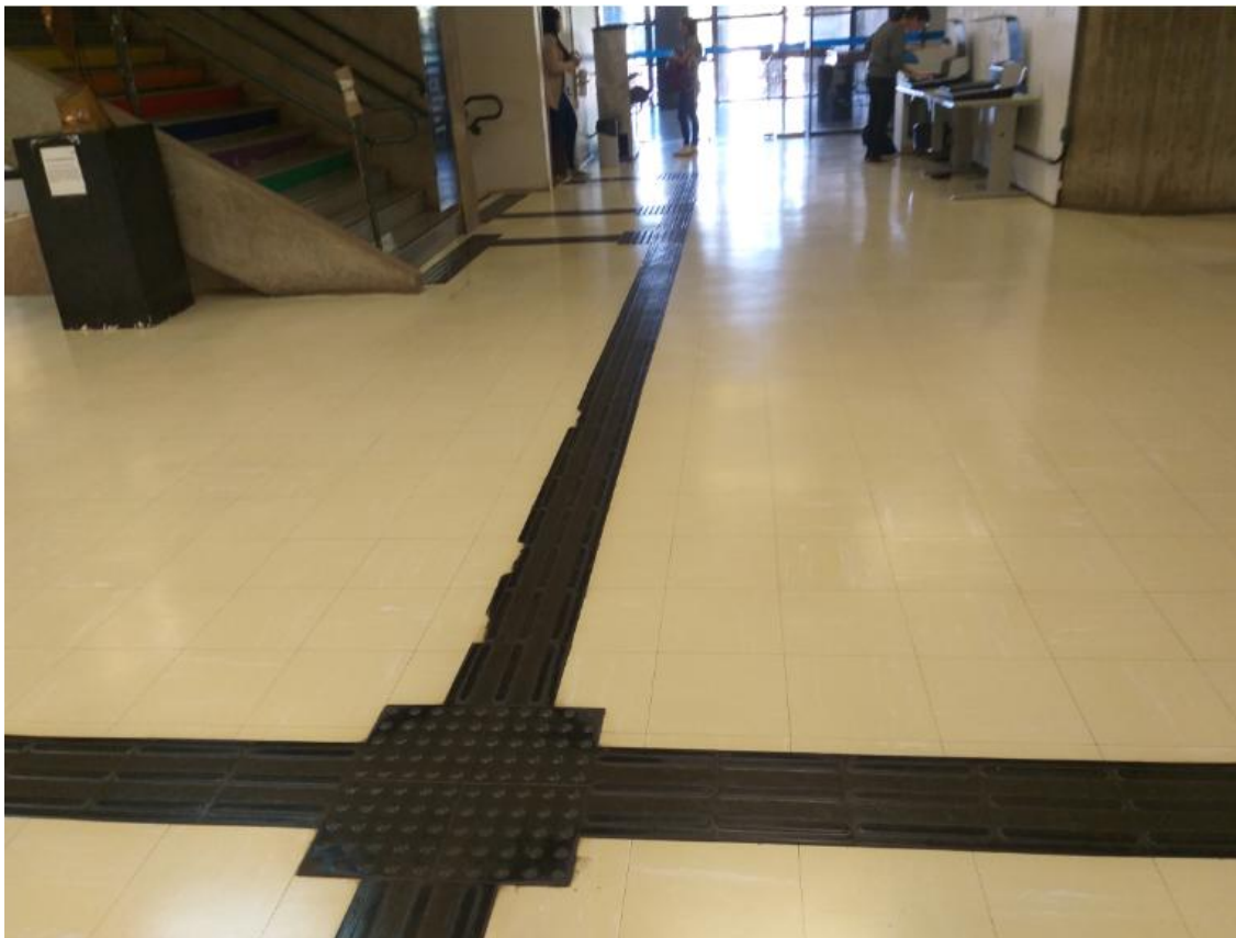
Figura 13 – Fotografia do piso tátil após a opção Outras
