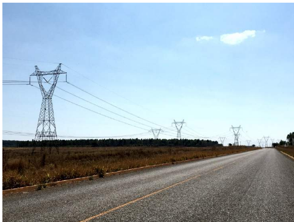
[f.118] Torres de transmissão da Usina Corumbá IV. Fonte: Pedro Máximo, 2019.
