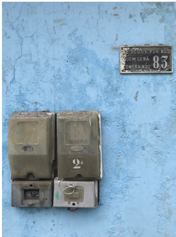
Figura 53. Parte da fachada da Casa 83 e Centro de Obaluaê, com medidores de energia independentes. Fonte: Foto do autor, 2020.
