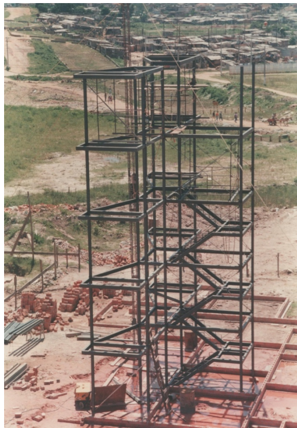
Figura 16. Escada metálica em obras no COPROMO em OSASCO, SP. Fonte: USINA CTAH. Acesso em 6 de dezembro de 2019.
