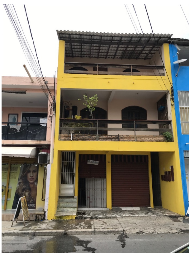
Figura 55. Edifício de uso residencial com três unidades habitacionais, na Boca do Rio. A partir dos elementos arquitetônicos como janelas e guarda-corpos, é possível notar as marcas das intervenções na fachada e na estrutura da edificação.
